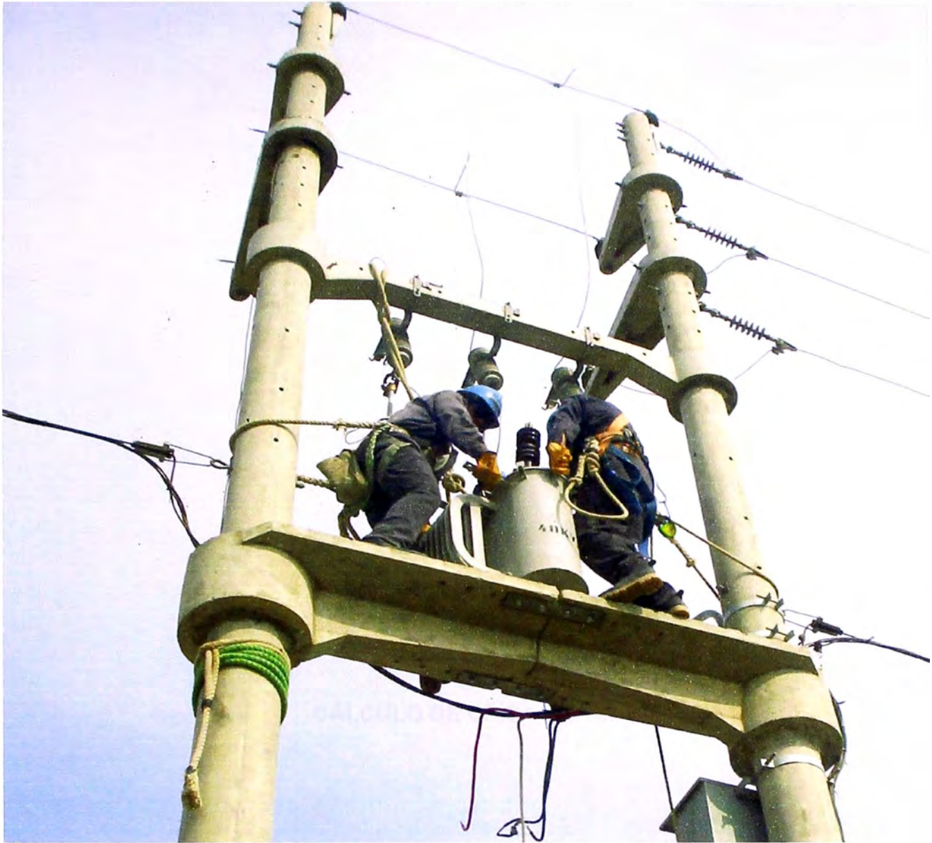
c.3 Armado de Subestación Trifásica Biposte con Instalación de Transformador, Tablero y Seccionadores en la Red Primaria y Armados propios de RS: E3 de Anclaje, además se aprecia la Luminaria y Lámpara instaladas
