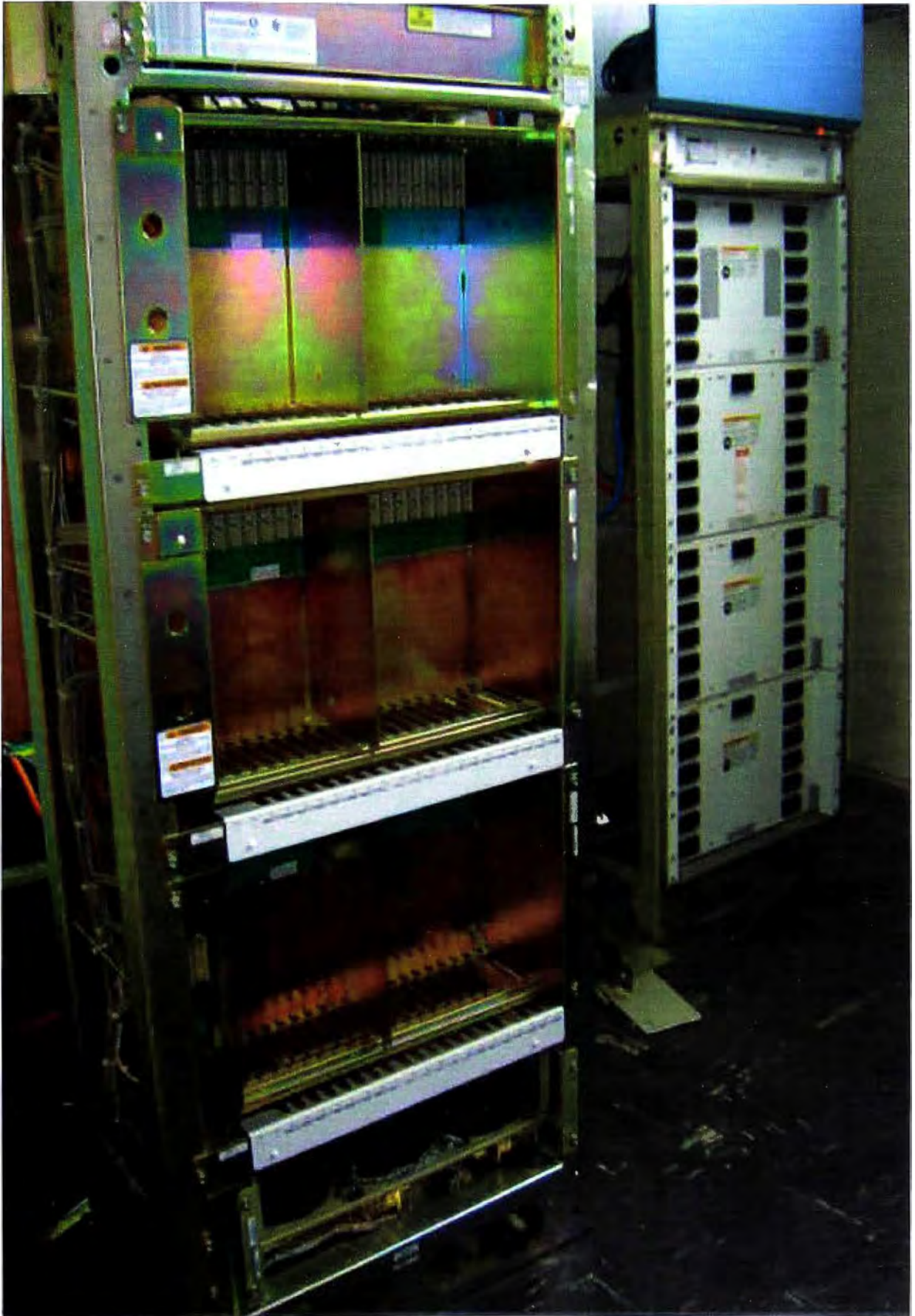
Bastidor con magazine de abonado LPZ100, de procesador regional, transporte, y servicio
