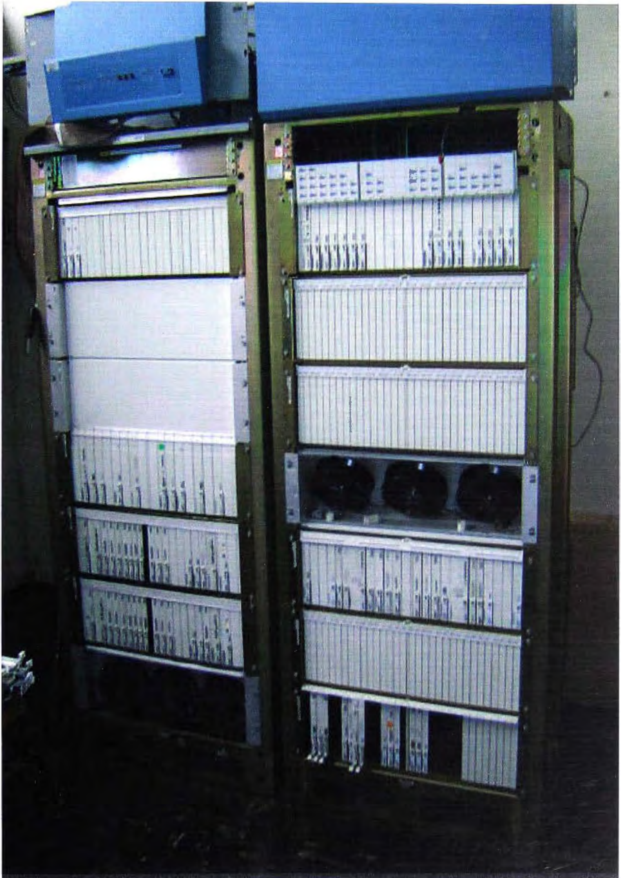
Bastidor con magazín de procesador, transporte, servicio y de abonado
