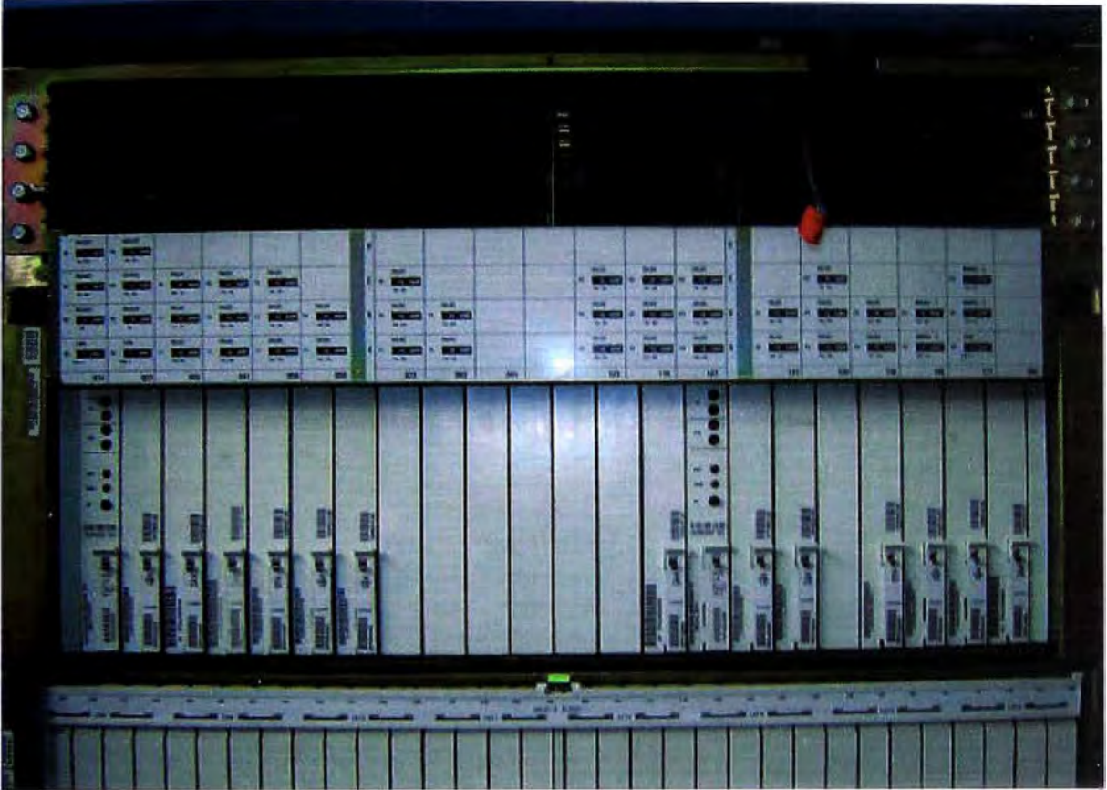
Magazín de acceso metálico, de pruebas de línea de abonado
