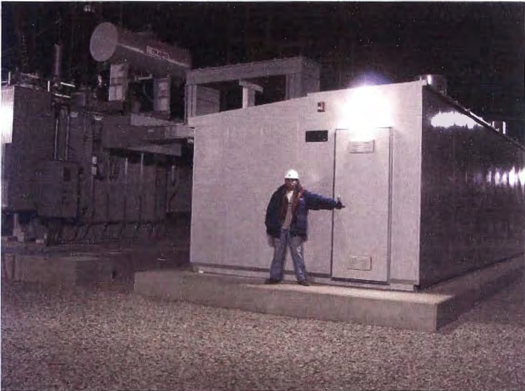
VISTA EXTERIOR DEL TRANSFORMADOR DE POTENCIA Y FRONTAL DEL WALKING
