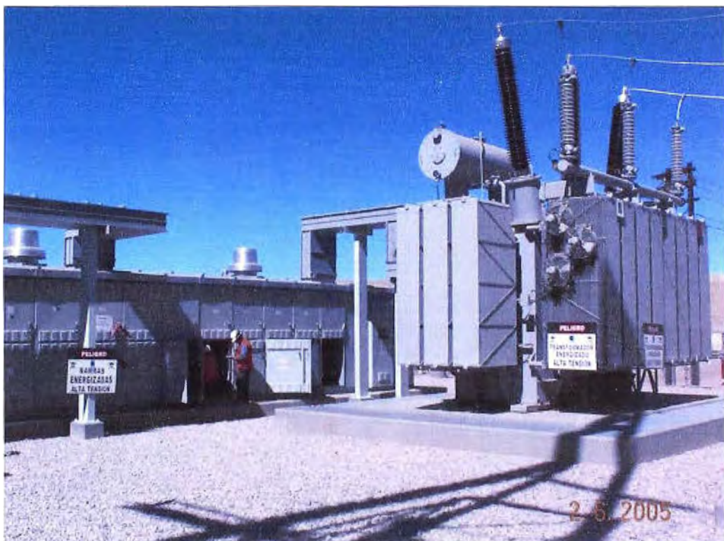
VISTA EXTERIOR DEL TRANSFORMADOR DE POTENCIA Y POSTERIOR DE WALKING.
