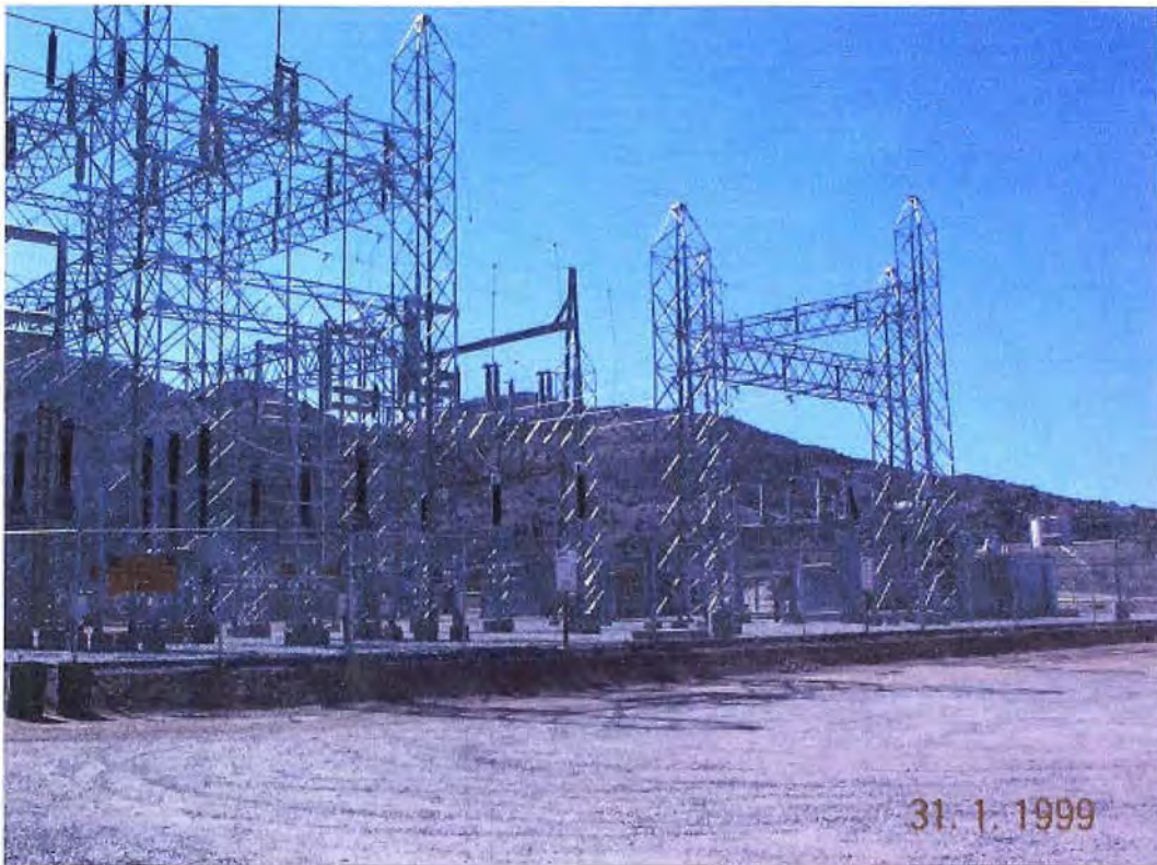
VISTA EXTERIOR PATIO DE LLAVES 138kV
