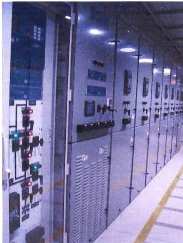
VISTA INTERIOR DE WALKING – SWITCHGEAR 13.8Kv EN OPERACIÓN
