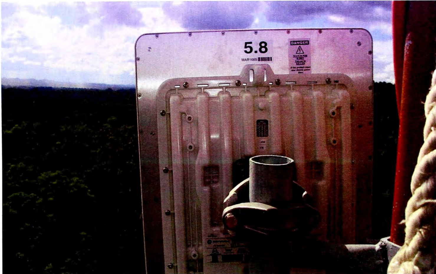
Fig.3.9 Apuntamiento de la Antena Fuente: Fotografía propia de la Empresa
