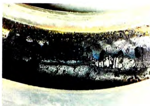
Figura 4.11-Daño en el butilo
