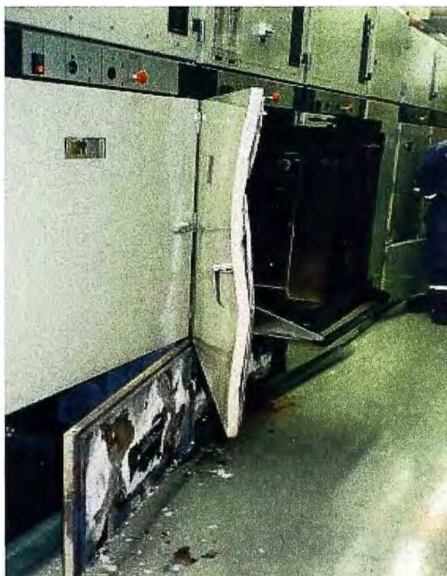
Figura 1.4: Explosión provocada por un cortocircuito.
