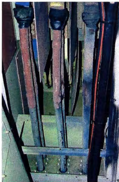
Figura 7.4: daño limitado en compartimiento de cables de Celda Metal Clad.
