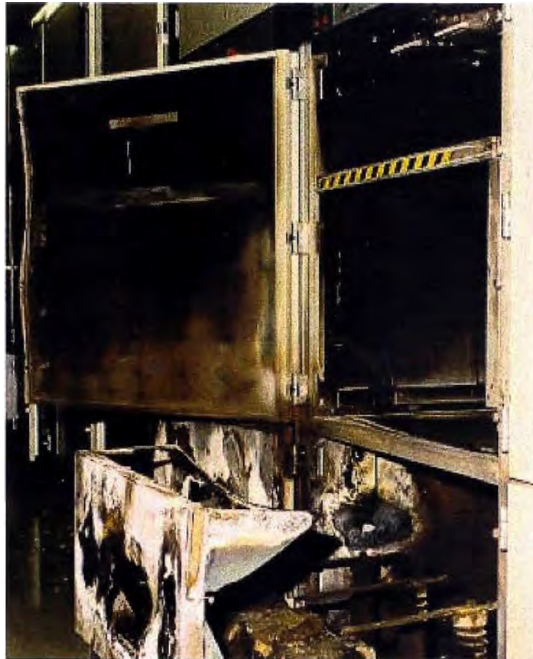
Figura 7.10: Celda no Metal Clad después de una falla de cortocircuito en subestación de 33kV en Kedah.
