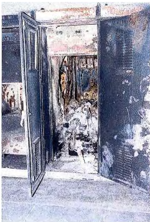
Figura 7.11: Celda no Metal Clad después de una falla de cortocircuito en subestación de 17.5kV en Brasil.
