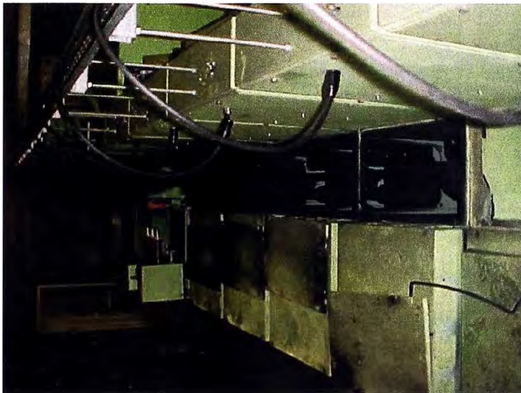
Figura 7.1: Celda Metal Clad con compartimiento de barras quemado.
