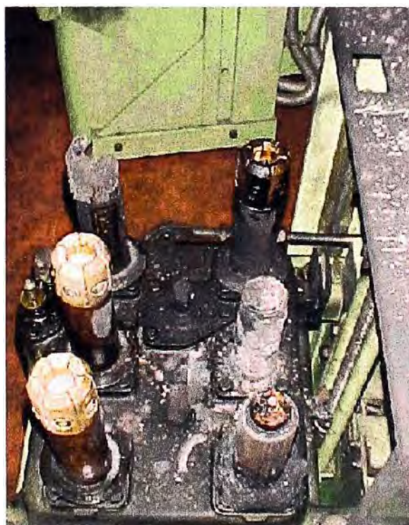
Figura 7.2: Interruptor dañado en Celda Metal Clad.
