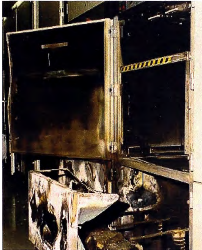
Figura 1.5: Explosión e incendio producto de un cortocircuito.
