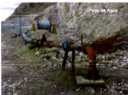
Figura 3.16: Tubería de Agua Fuente Antamina
