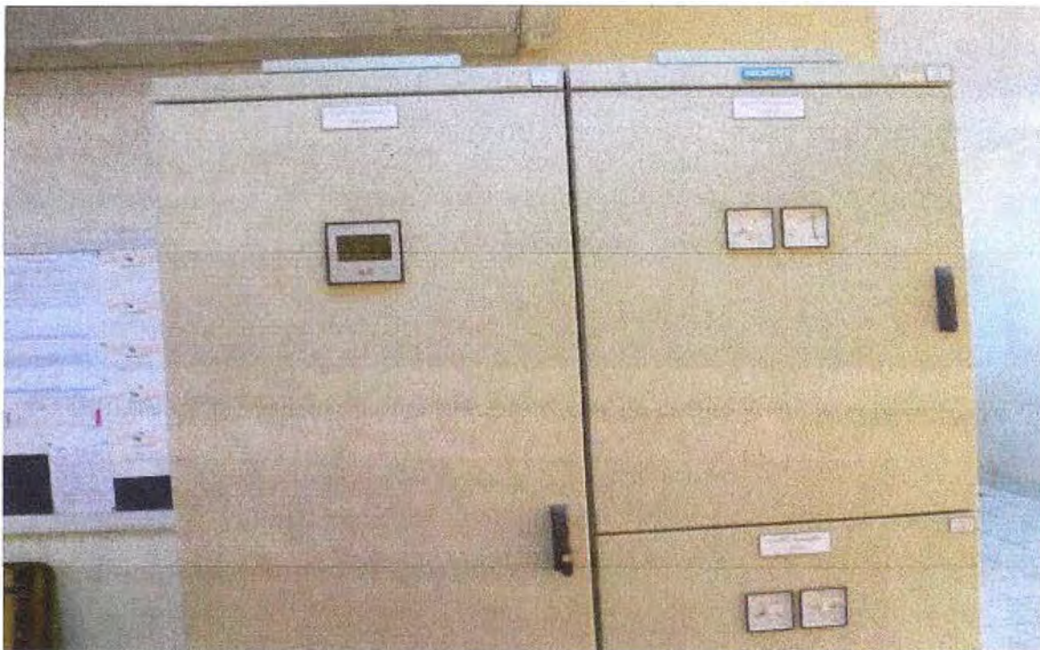
Figura 2.6 Servicio auxiliar ubicado en sala de mando
