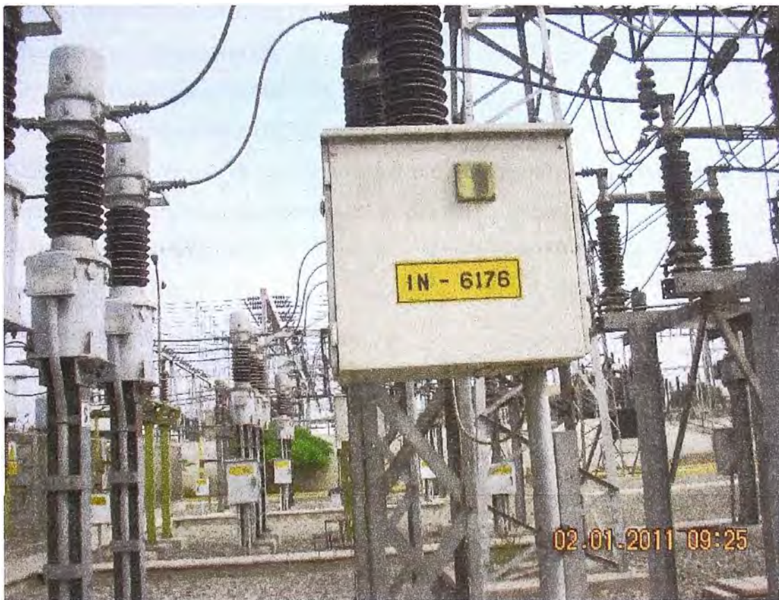
Figura 2.4 Equipos en patio de bancos
