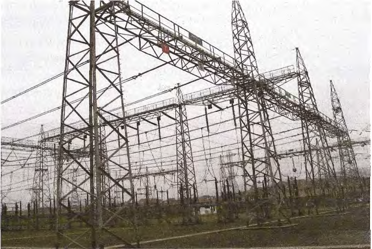
Figura 2.3 Equipos en patio inferior
