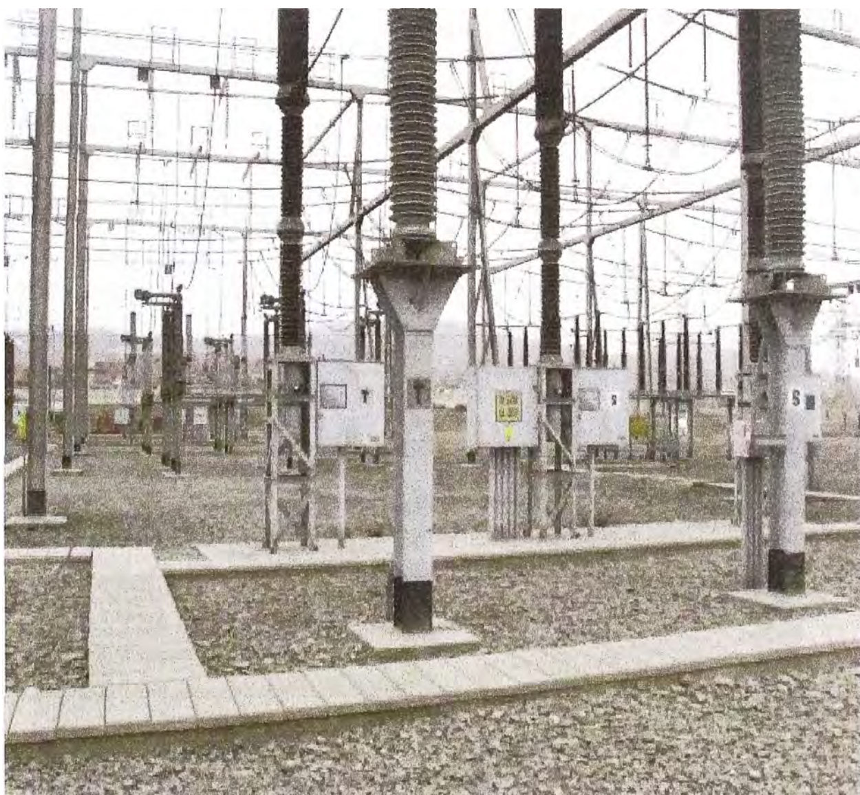
Figura 2.2 Equipos en patio superior
