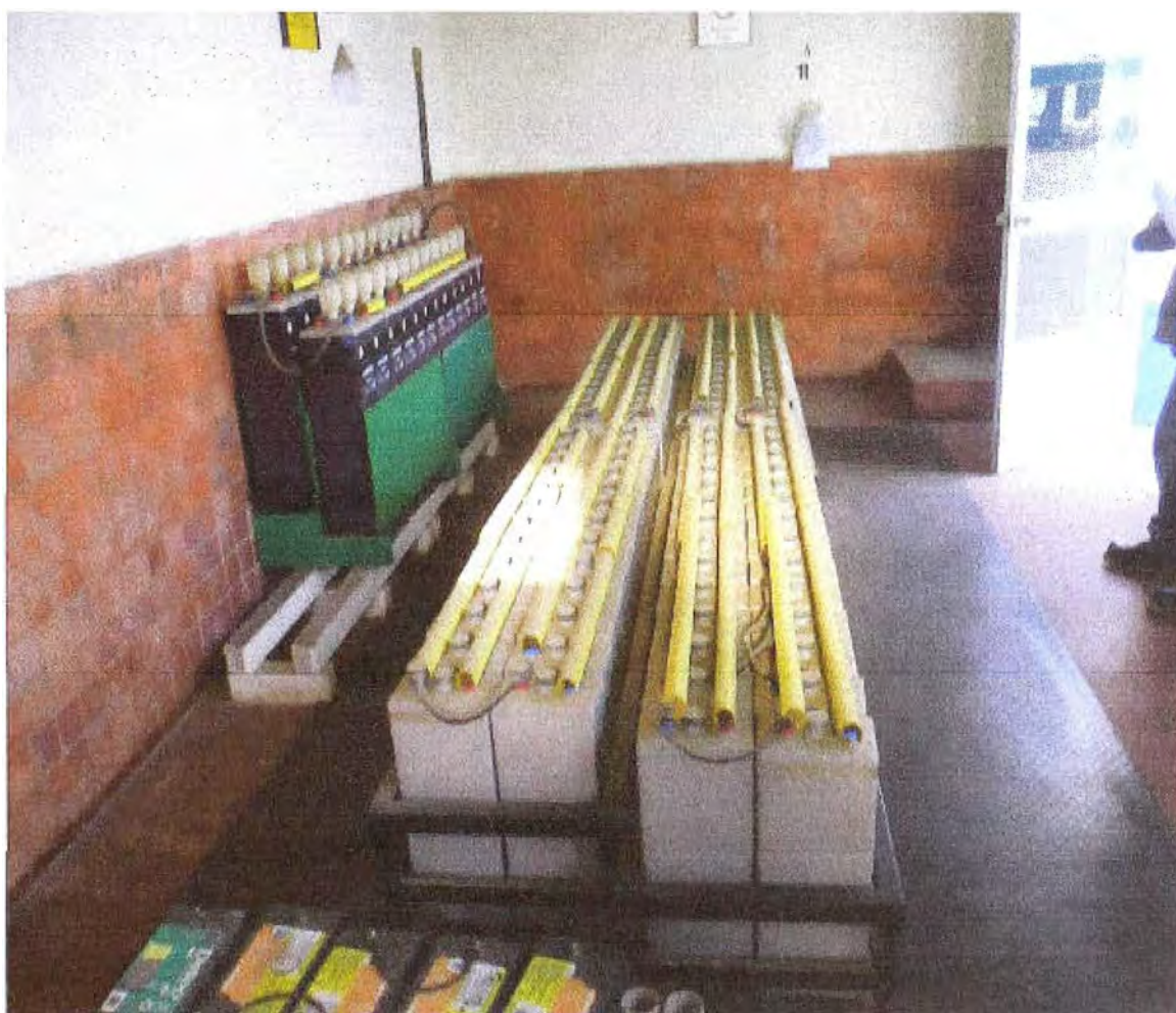
Figura 2.9 Banco de baterías
