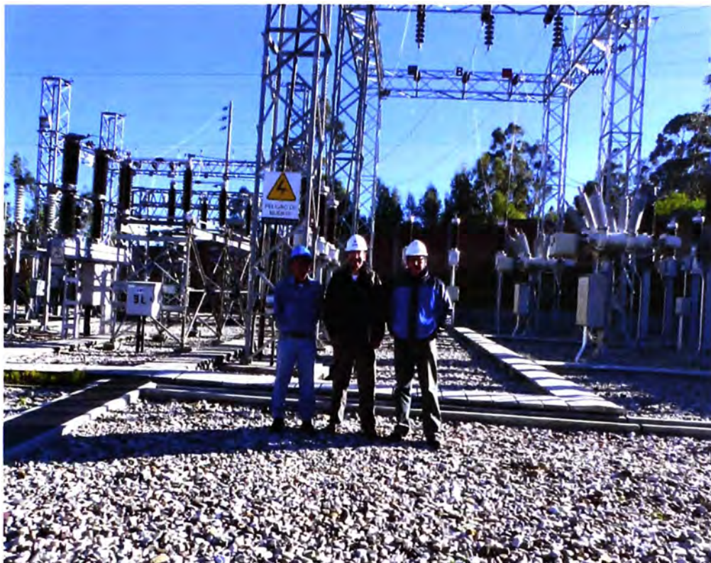
Foto N° 25: Salida LT 60 kV - SE Cajabamba (Cajabamba - Cajamarca)
