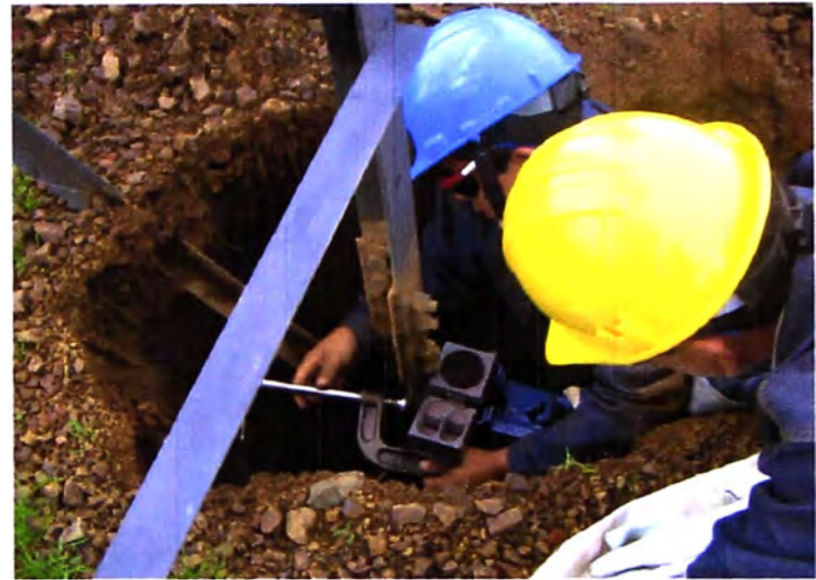
Foto N° 14: Empalme de la torre con la puesta a tierra
