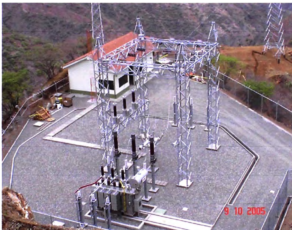
Foto N° 26: Llegada LT 60 kV - SE Morena (Pataz - La Libertad)
