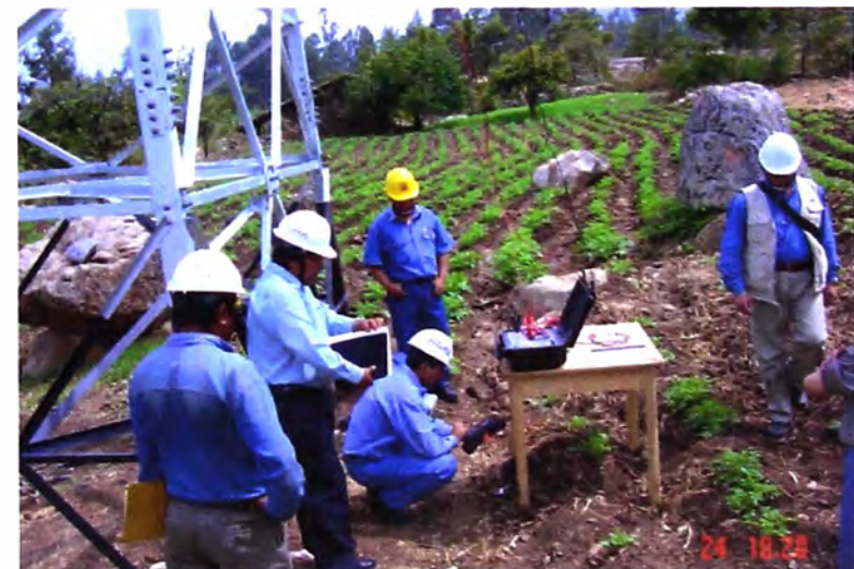
Foto N° 29: Medición de Aislamiento
