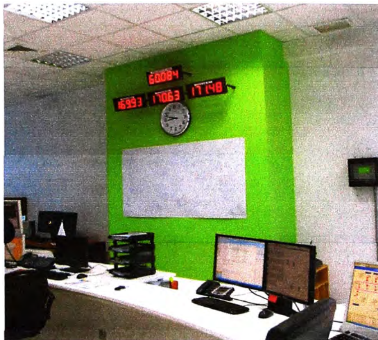
Fig. 2.3 Nivel de Control de Subestación.
