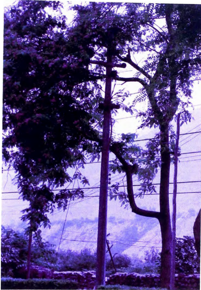
Vista general poste extremo de línea (Poste P-1)
