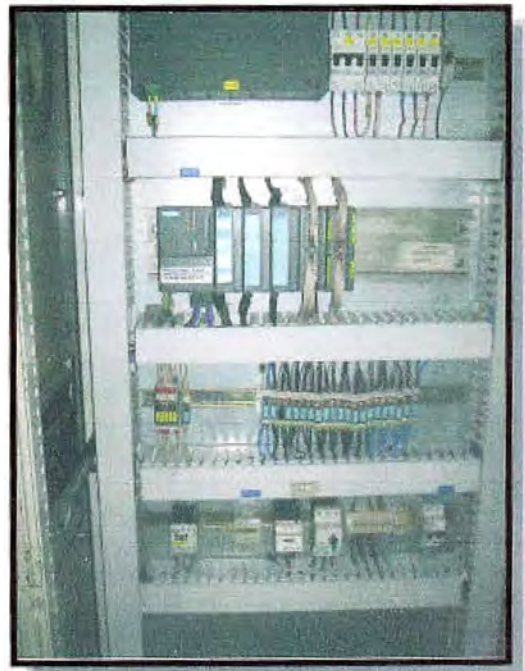
Fig. 3.12. - Tablero del extremo de Salida con módulo ET200
