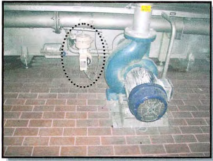
Fig. 3.5. Motobomba de tanque de enfriamiento con válvula de succión agua caliente. Ítems 5 y 14
