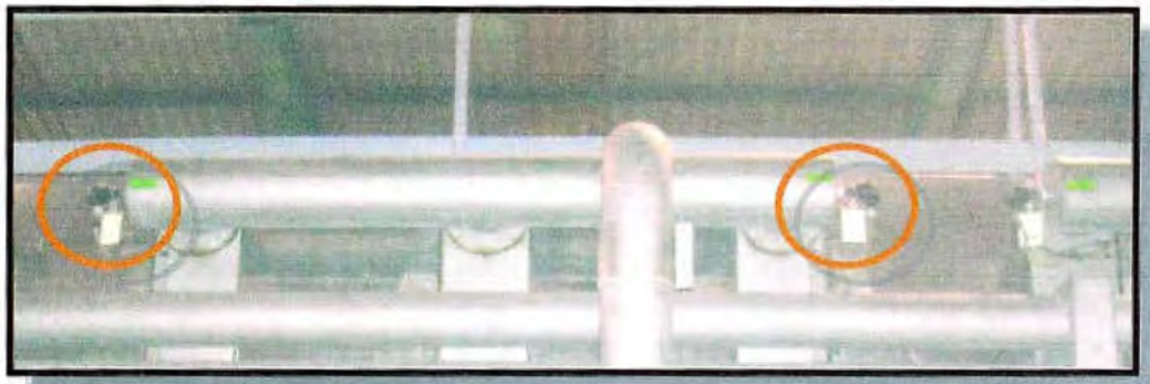
Fig. 3.8. PT100 de Control redundante- Tanques de Pasteurización. Ítem 21
