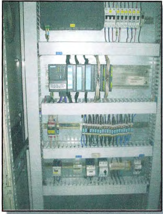
Fig. 3.10. Tablero Principal con CPU-300
