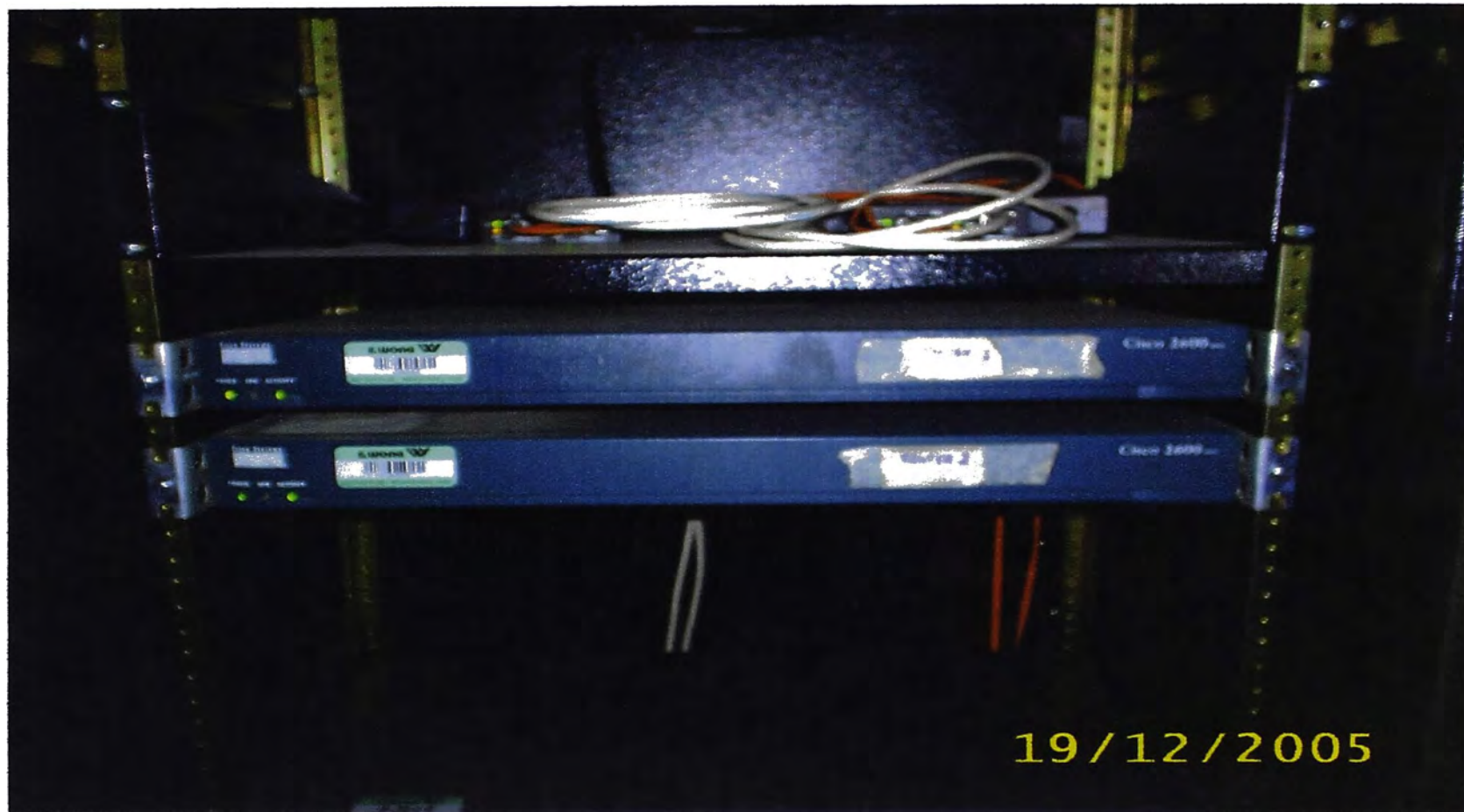
Figura A.3 - ROUTER CISCO 2611 -Con memorias: DRAM 32MB FLASH: 64MB - Con interfaces VIC - FXO
