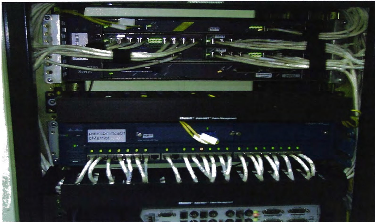
Figura A.4 - Conectorizacion de Equipos: Router Cisco 7200 y Catalyst 2924
