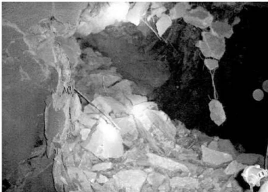
Figura 3.5.- Rotura del macizo rocoso por estallido de rocas (rock burst)
