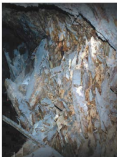
Figura 3.4.- Rotura del macizo rocoso por lajamiento (spalling)
