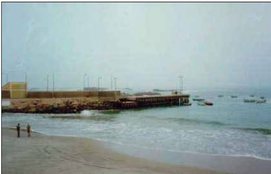
Foto N° 7.6.- Muelle Fondepes en Chala, el mar se retiro dejando al descubierto los pilotes del cabezo de muelle, el retiro fue aproximadamente +/- 100 m. Coordenadas: 15°50.151' S; 74°17.371'W
