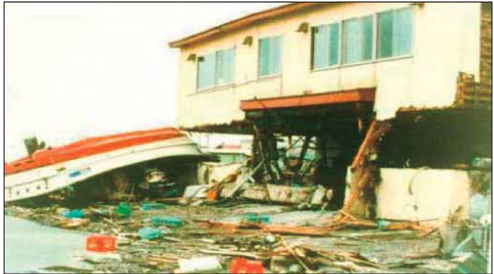
Foto N° 3.5 Daños producidos por Fuerzas de Impacto
