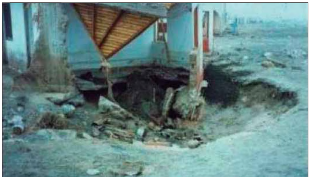
Foto N° 3.2 Daños producidos por Socavamiento en el Balneario de Camaná por el Tsunami.
