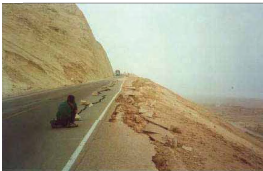
Foto N° 7.45.- Vista tomada hacia el Sur la carretera en mal estado debido al terremoto.
