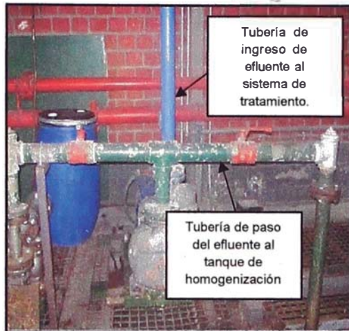
Figura 5.5 Tubería celeste no presenta válvula para el ingreso de efluente
