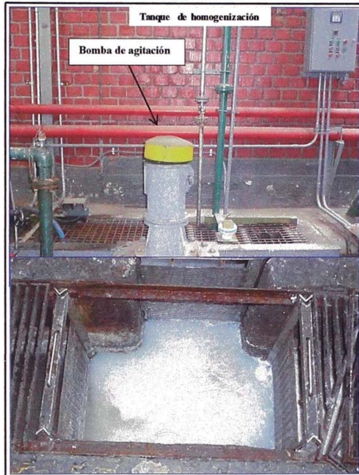
Figura 5.1 Tanque de homogenización
