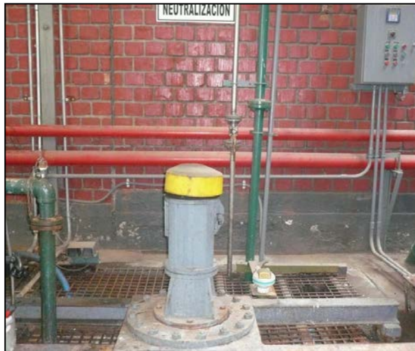
Figura 4.16 Vista del motor de la bomba de agitación en el tanque de homogenización
