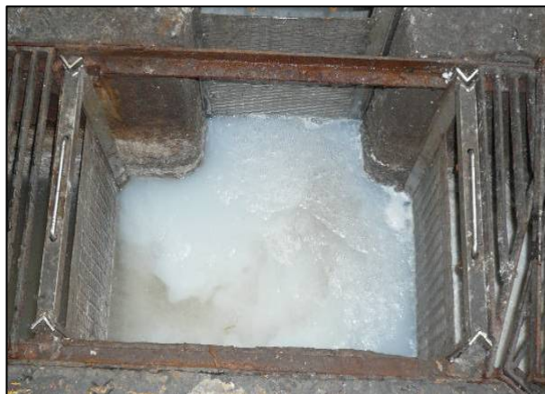
Figura 4.17 Vista del tanque de homogenización
