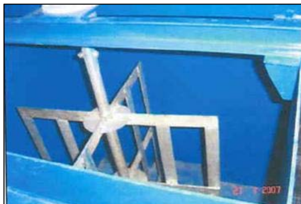
Figura 4.19 Vista del tanque de floculación
