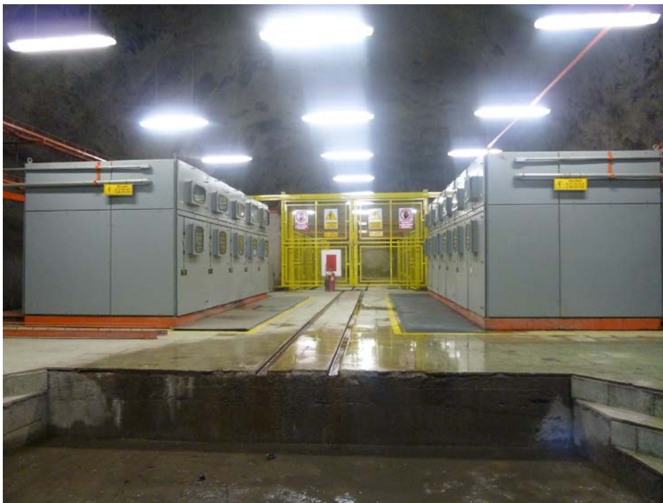
FIGURA 44. SUBESTACIÓN 4120 MINA CARMEN
