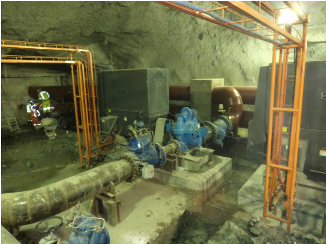
FIGURA 45. ACCESORIOS USADOS EN LA ESTACIÓN DE BOMBEO NIVEL 3970 MINA CARMEN
