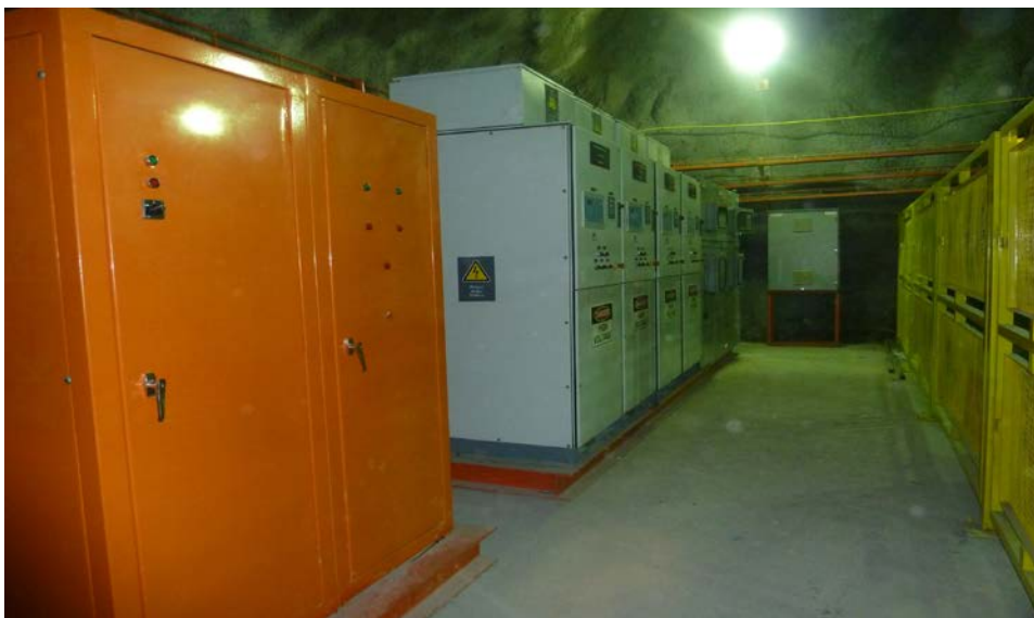
FIGURA 51. CELDAS Y TABLEROS ELÉCTRICOS EN CÁMARA DE BOMBAS
