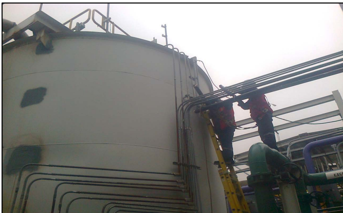
Figura 5.3 Implementación de línea de dosificación de peróxido de hidrogeno al tanque de cloración
