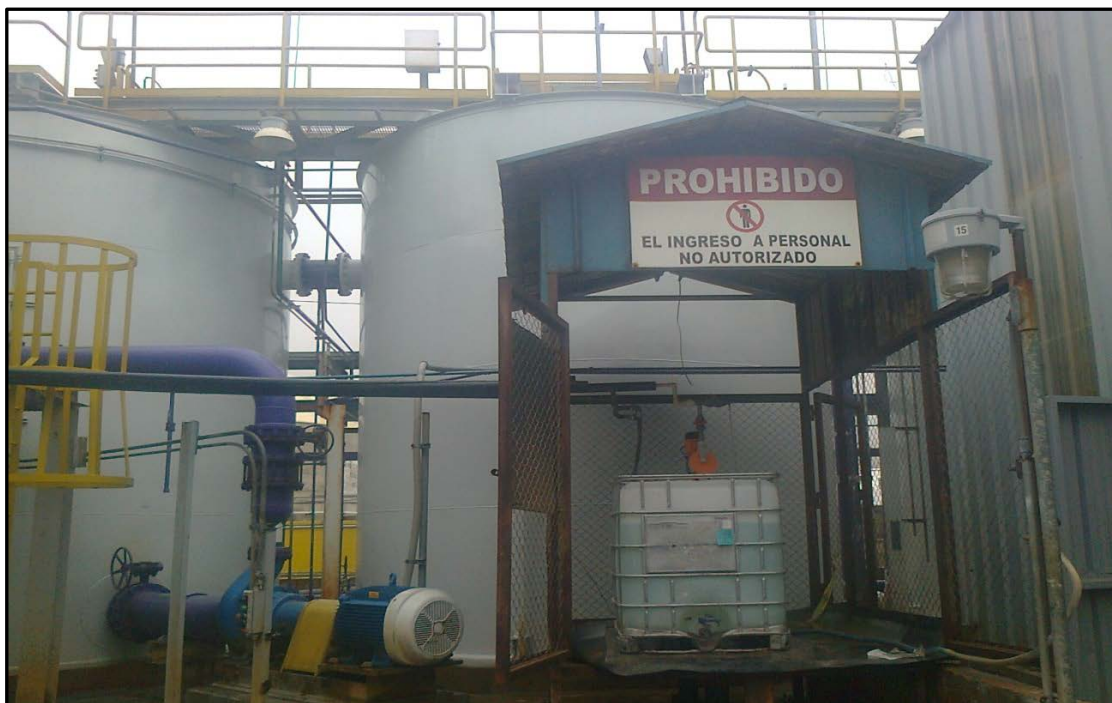
Figura 5.4 Implementación de área de recepción de hoover de peróxido de hidrogeno y sistema de bombeo
