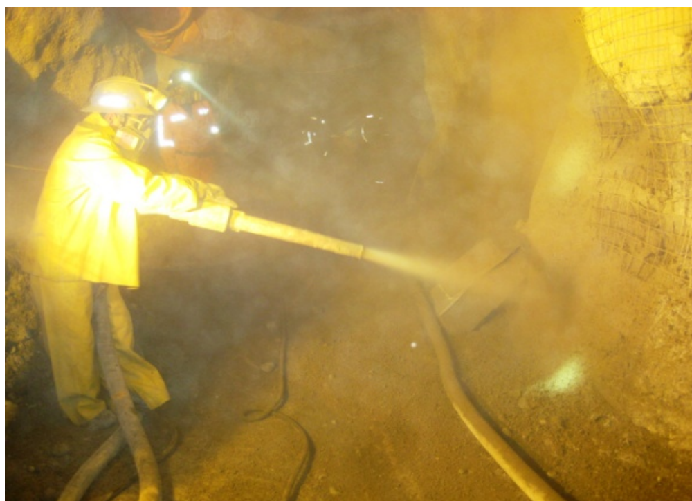
Foto 11: Las E.E. en coordinación con el área de Geomecánica obtendrán un panel de muestra para ser ensayada en un laboratorio de concretos. Prueba in situ de tiempo inicial de fraguado.
