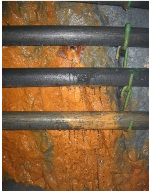
Fig. Nº 27 Son las filtraciones a través de discontinuidad especialmente con relleno.
