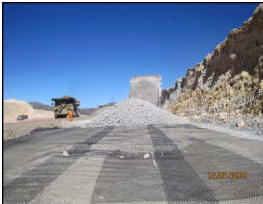
Figura 16. Colocación de la segunda capa de material de rodadura sobre la geo-malla.
