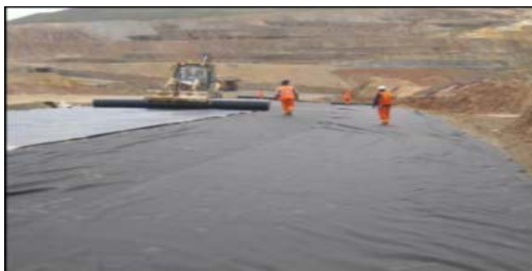
Figura 14. Colocación de la segunda capa de geotextil de protección sobre la geo-membrana.
