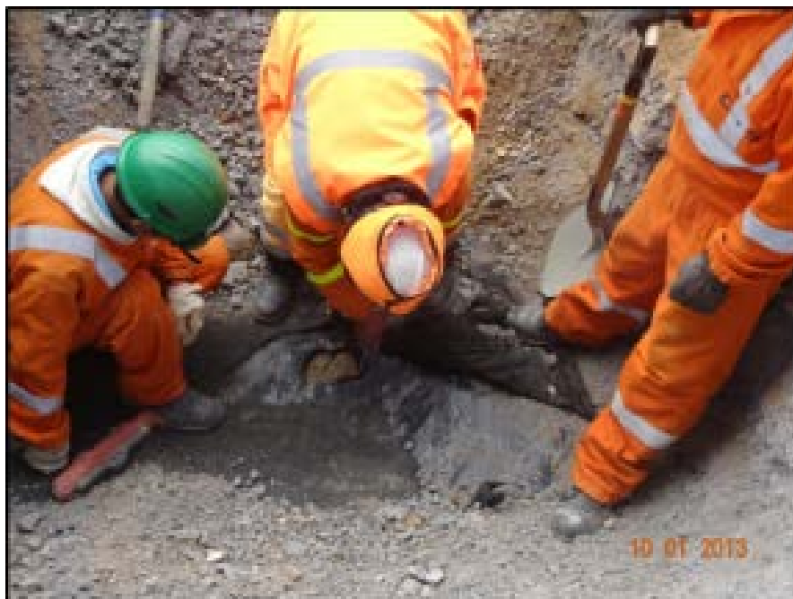
Figura 19. Exhumación del geo-compuesto impermeable entre la Base y la Capa de Rodadura.
