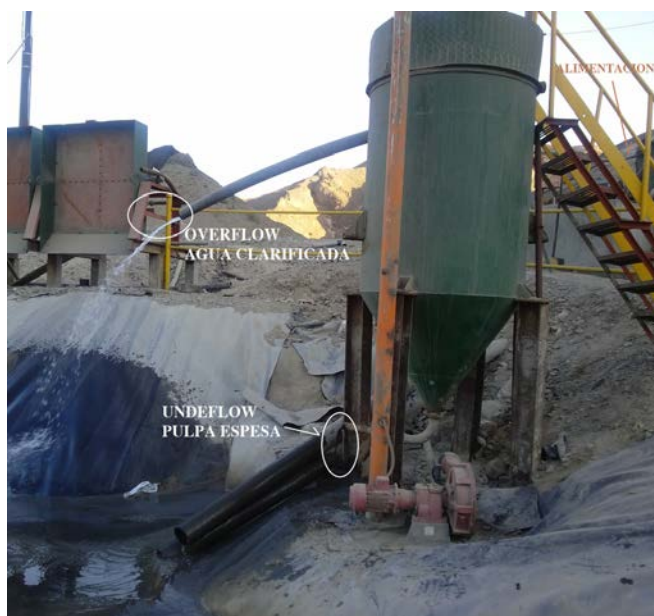
Fig. 3.7 Planta piloto Cono espesador Clarificador de relaves
