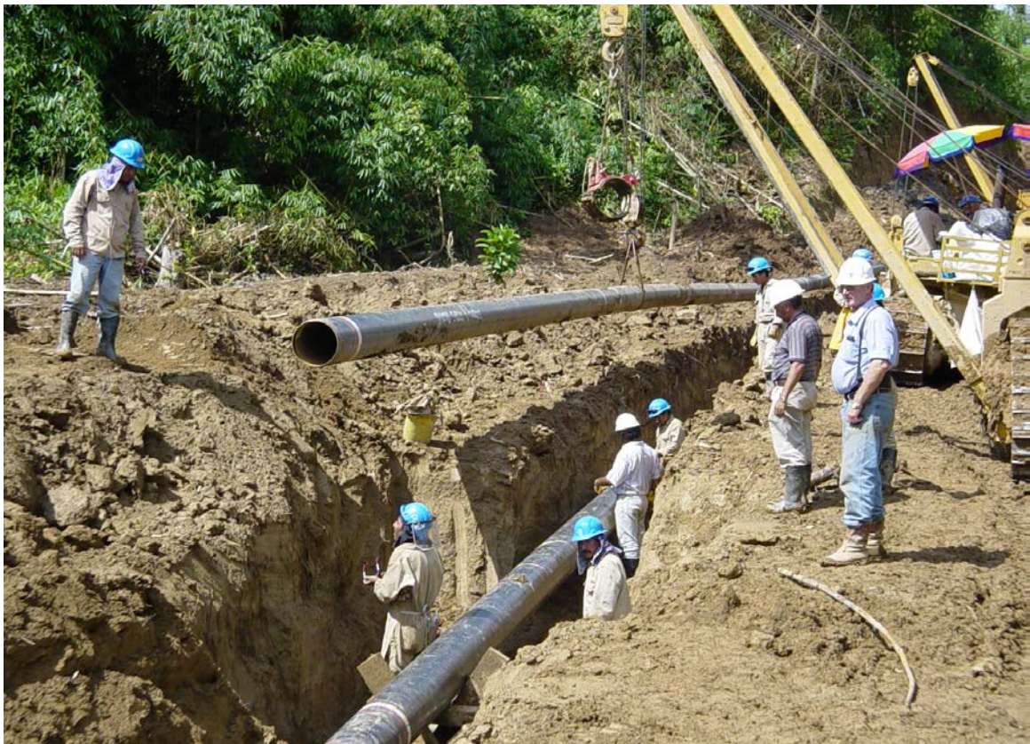
Empalmes de Tuberías
