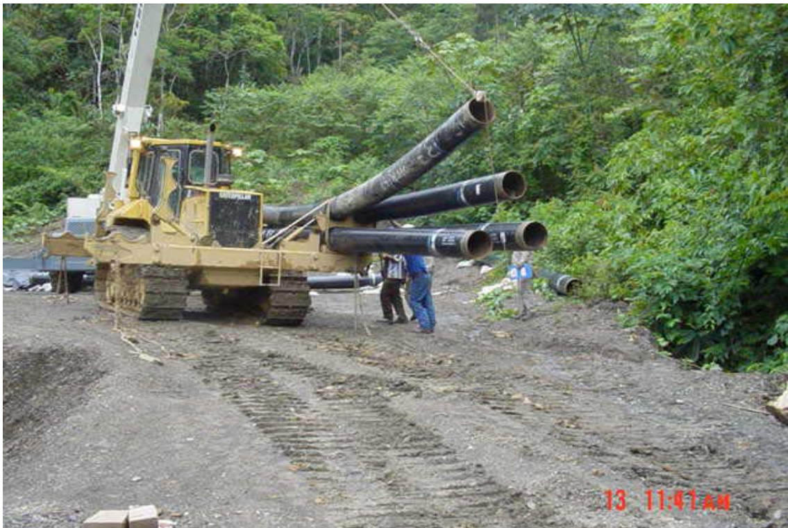
Figura 4.7.2 Riego de Tuberías
