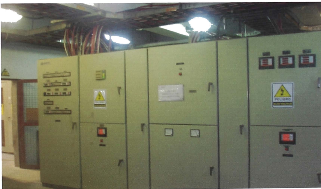
Figura: 1.7 Tablero de distribución tipo Back-to-Back
