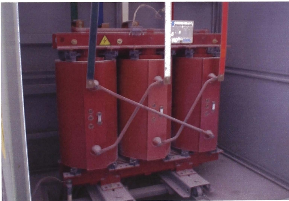
Figura: 1.6 Transformador TRIHAL de 1000 kVA
