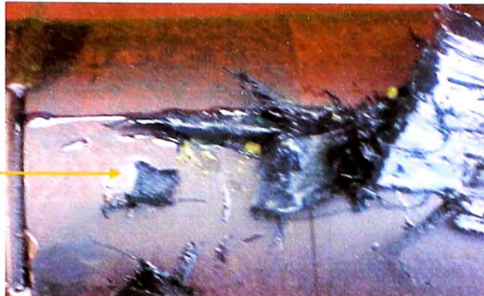
Fig. N° 2.6: Daños en el recubrimiento del cable cerca a la cabeza terminal del mismo
