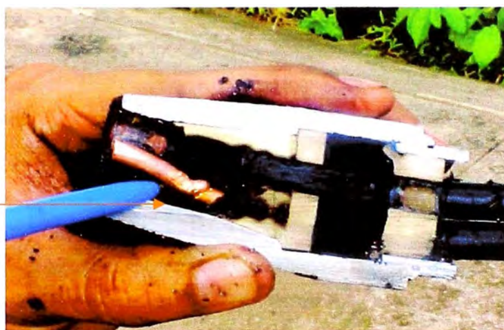
Fig. N° 2.8: Evidencias de cortocircuito en la cabeza terminal del cable de fondo
