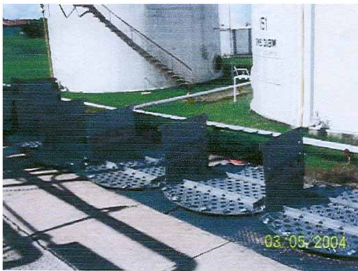
Foto N°8. Vista de los Nuevos Platos.
