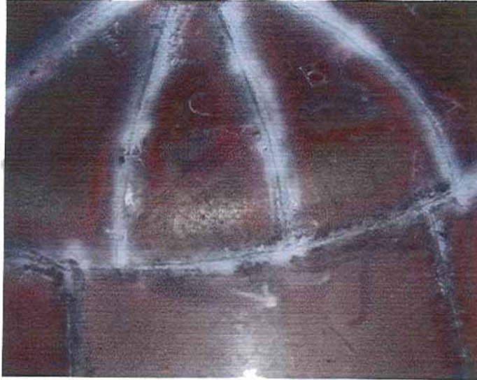
Foto N°13. Aplicación final de Lining de Monel en el Domo de la Columna.
