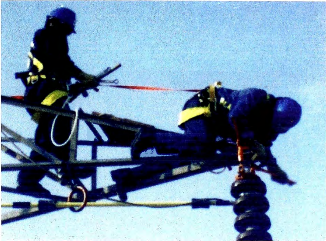
Foto (7.9) – Extracción de chaveta del aislador mediante el “Extractor de Chaveta”.
