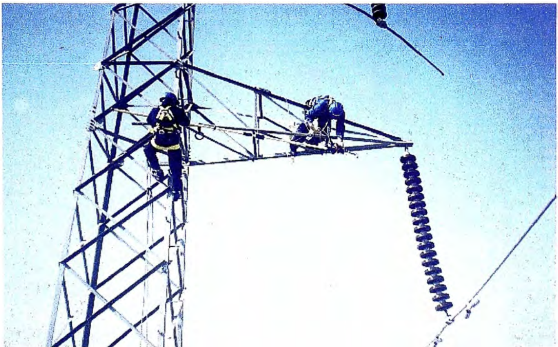
Foto (7.2) – Instalación tierra temporaria, apoyo para acoplar la pinza en punta de la pértiga.
