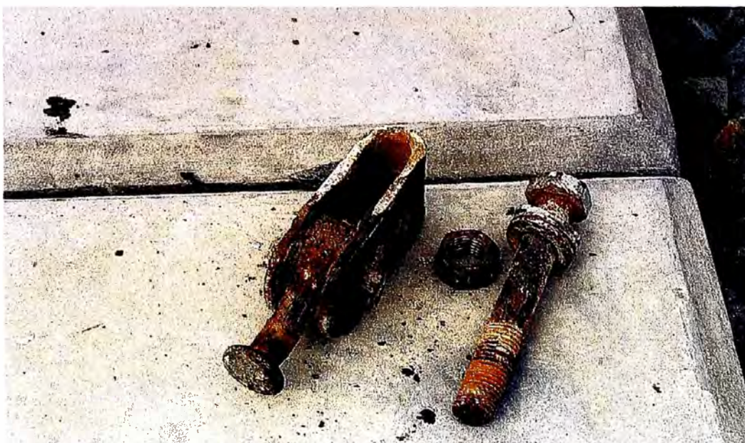
Foto (1.2) - Corrosión grado 5 de accesorios de sujeción de las cadenas de aisladores de Subestación Chimbote I - Perú
