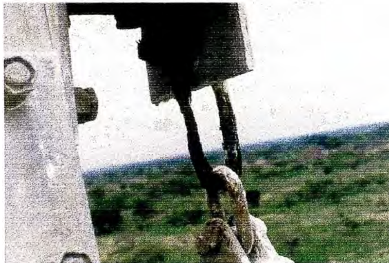
Foto (1.4) – Corrosión grado 5 de accesorios de una línea de transmisión Colombia
