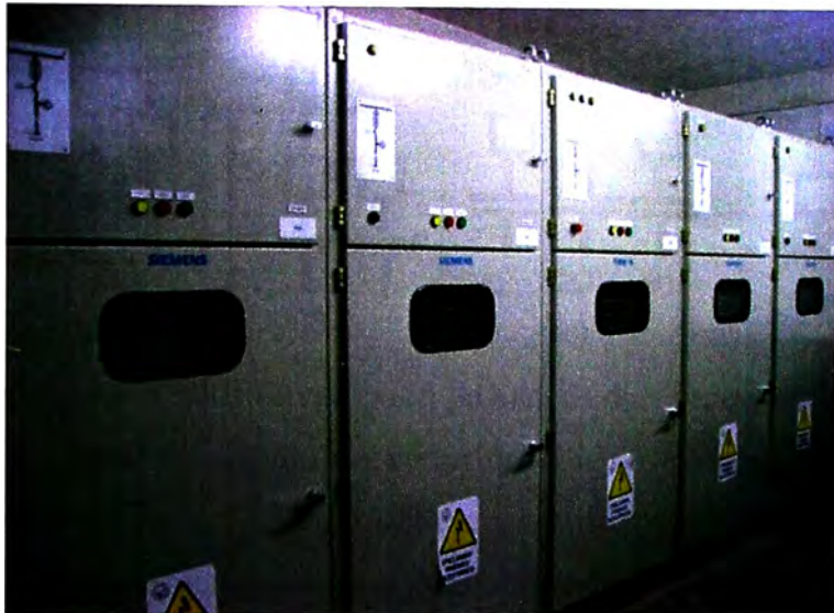
Fig. 2.19 Banco de condensadores de 6.6kV y 5x500 kVAR.
