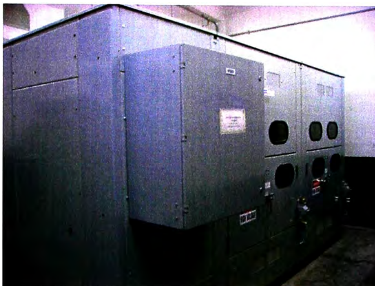
Fig. 2.18 Banco de condensadores de 2.3kV y 3150kVAR.
