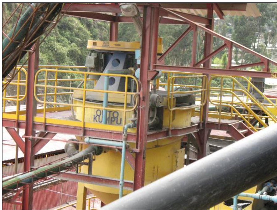
Figura 4.2. – Celda Flotación SK-240 instalado
