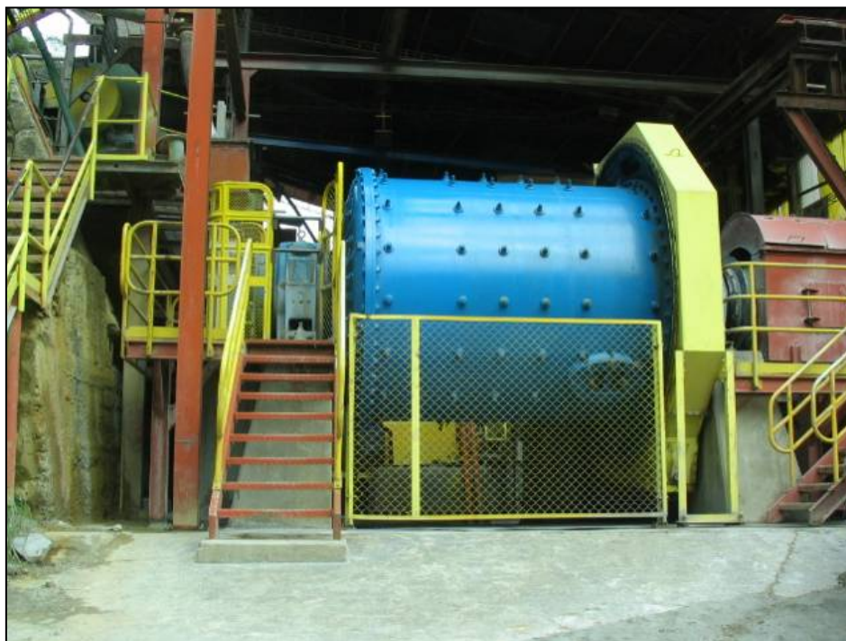
Figura 4.1. – Molino 8' x10' N°2 secundario instalado
