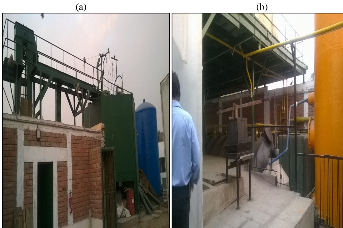
Figura 6.2 Planta de generación de biogás del hipódromo de Monterrico. (a) Sistema de transporte del estiércol equino, (b) Biodigestor tipo UASB y bolsa de recepción de biogás.
