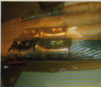
FIG 8. Fotografía de punto caliente detectado con termografía.
