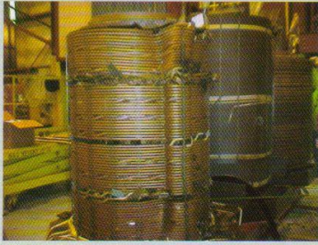
FIG 7. Fotografía de bobinado derrumbado y conexiones flojas en un transformador ensayado con FRA.
