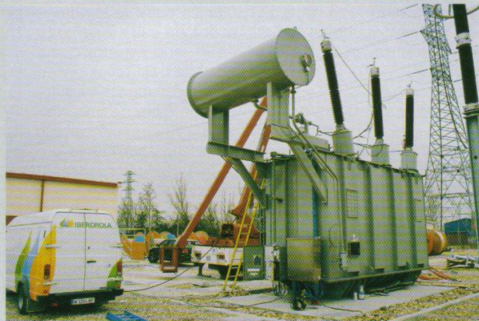
F161. Ensayos de campo a un transformador de potencia en su puesta en servicio (50MVA).
