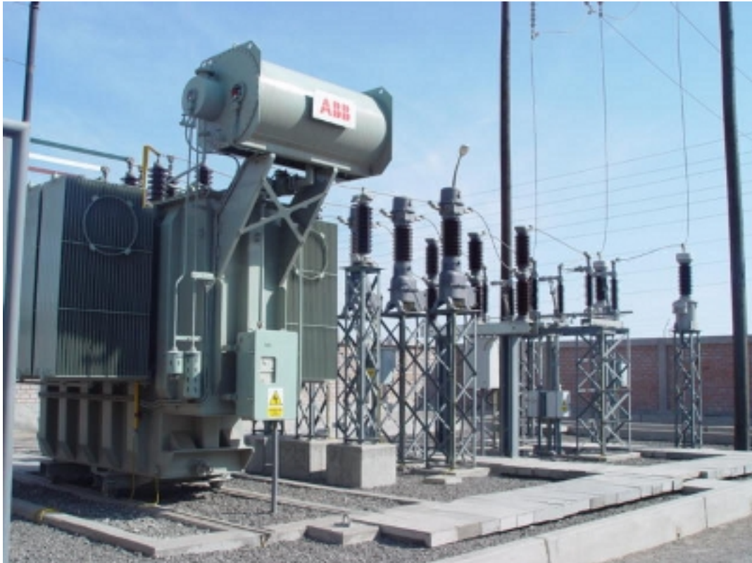
Figura 3.2: Subestación de Transformación para el sistema de distribución de la Minera Shougang. Relación de transformación 60/34,5kV
