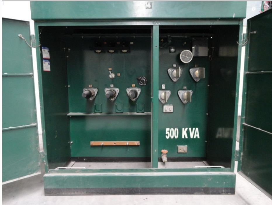
Figura 3.6: Transformador Tipo Pedestal de 500kVA
