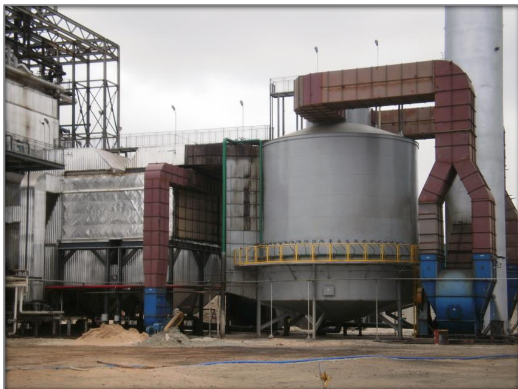
Foto.2.10 Lavador de gases de la caldera bagacera (Cortesía Maple Etanol S.R.L).
