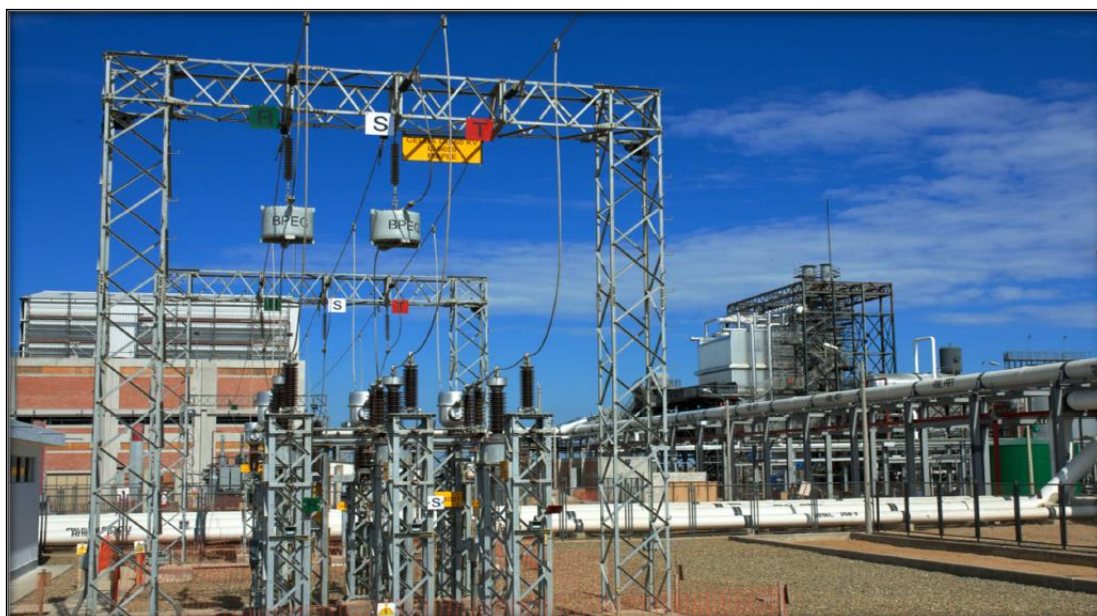
Foto.2.13 Subestación eléctrica en 60Kv (Cortesía Maple Etanol S.R.L).
