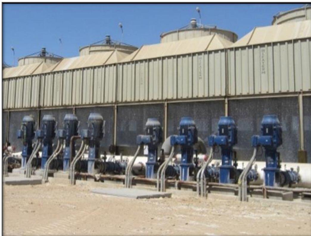
Foto.2.12 Torres de enfriamiento (Cortesía Maple Etanol S.R.L).
