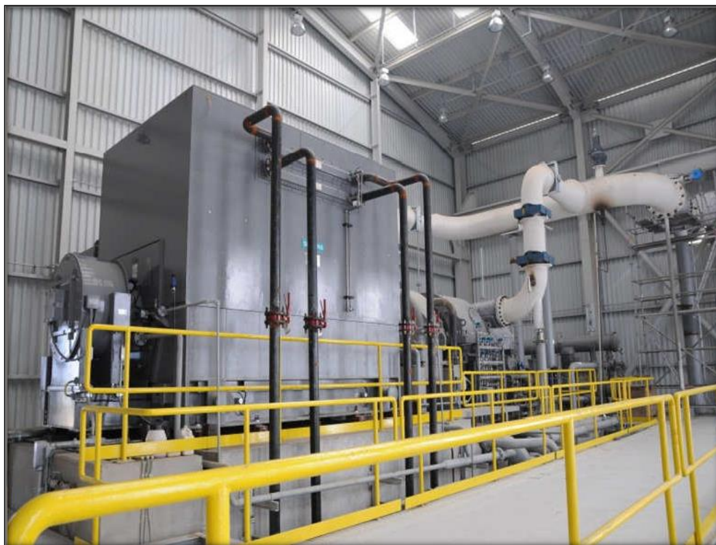
Foto.2.11 Turbogenerador (Cortesía Maple Etanol S.R.L).
