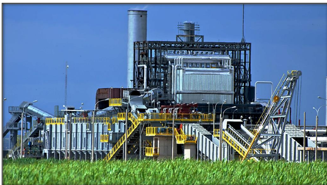
Foto.2.9 Vista panorámica de la caldera bagacera (Cortesía Maple Etanol S.R.L).
