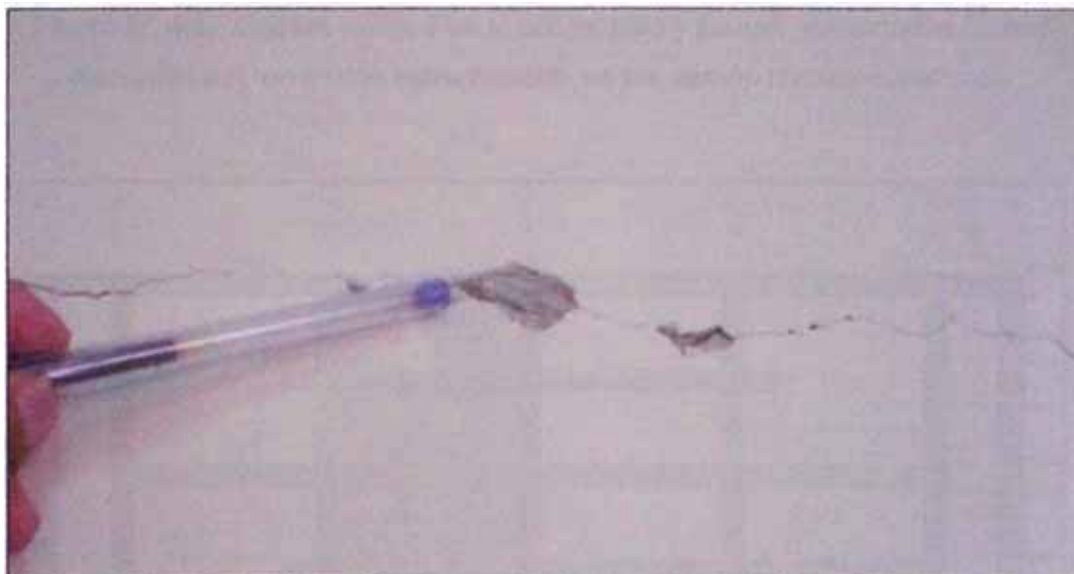
Figura N° 4.3.- Fisura horizontal en muro estructural.
