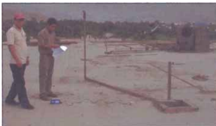
Figura N° 3.9.- Vista de la medición de vibraciones ambientales en la azotea de la Biblioteca (equipo de IGR).
