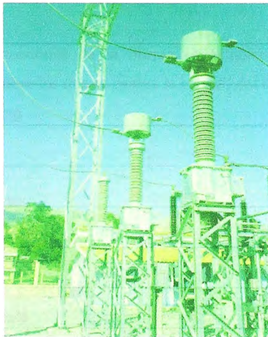
Figura 2.12 Transformadores de Medida
