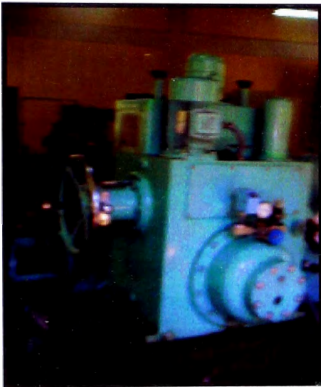
FOTO N° 11.- Regulador de Velocidad grupo Chino, presentaba pérdidas de aceite y problemas en el sistema de amortiguación.
