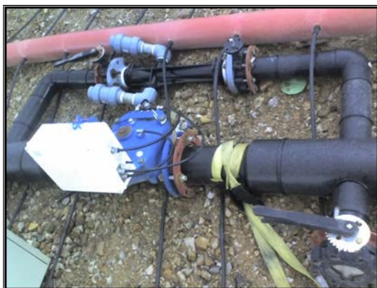
Figura N o 4.2 Cambio de válvula automatizada
