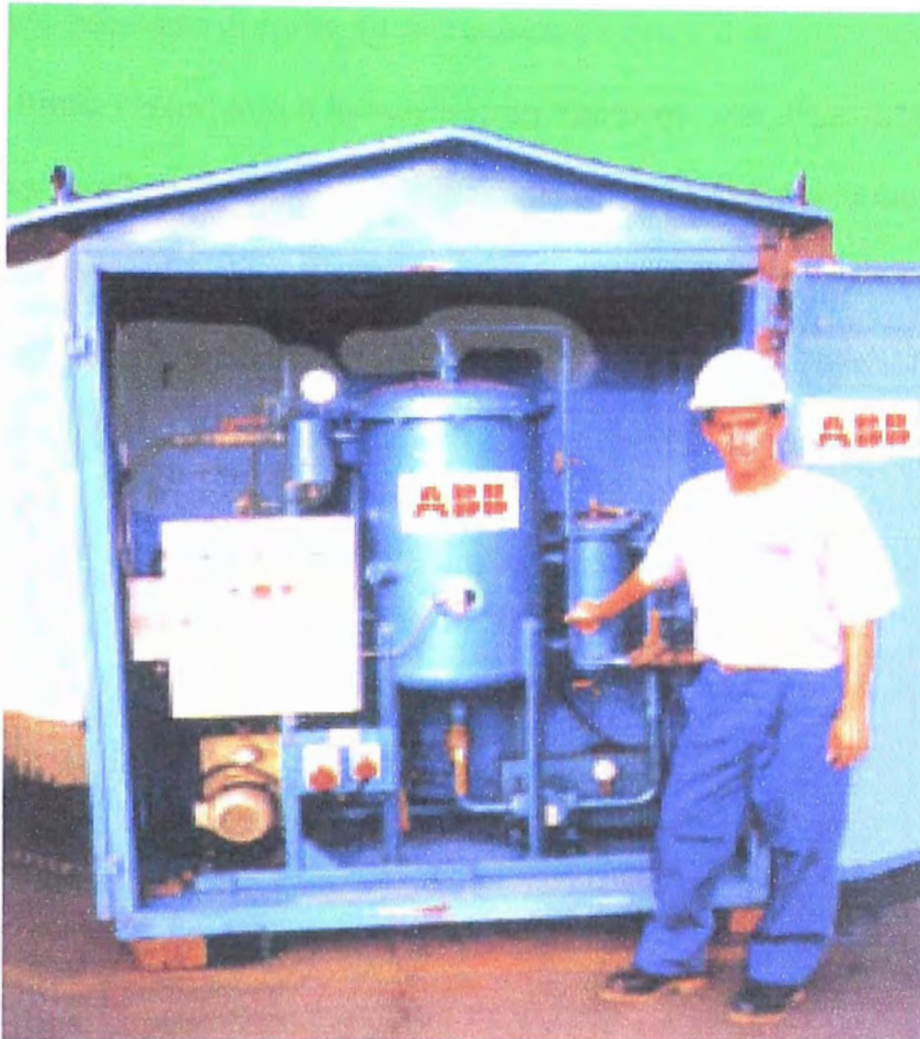
Fig. 2-15 Equipo Especial de Tratamiento de Aceite.
