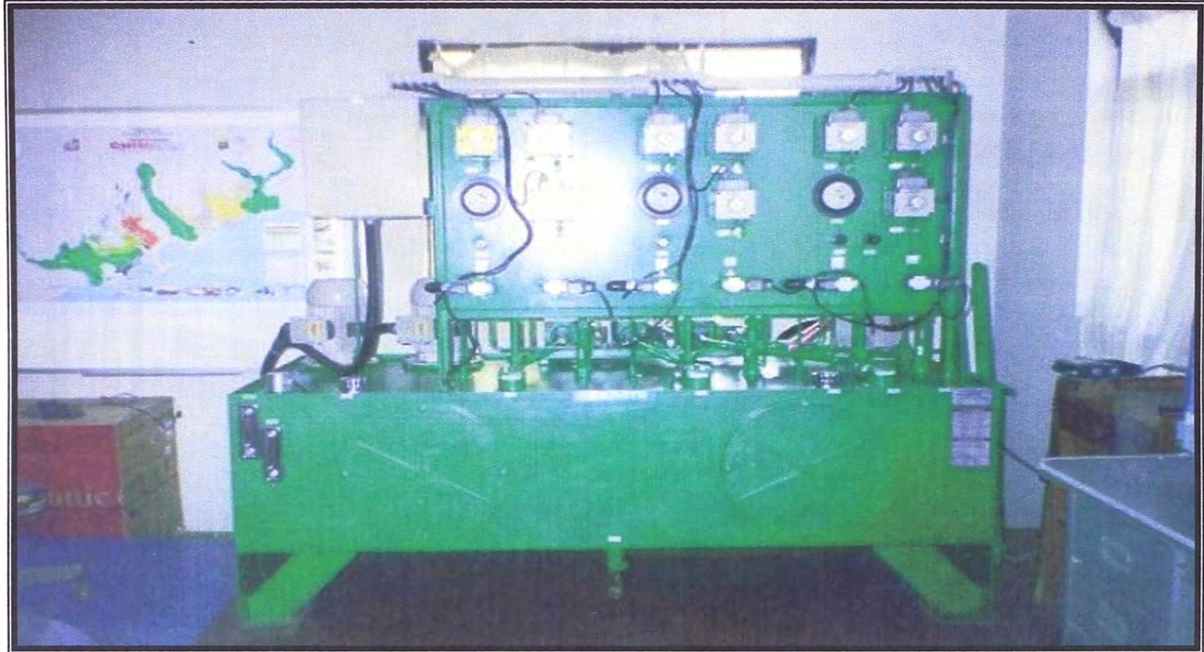
SISTEMA ÓLEO HIDRÁULICO EN SALA DE CONTROL. BOCATOMA LA HUACA
