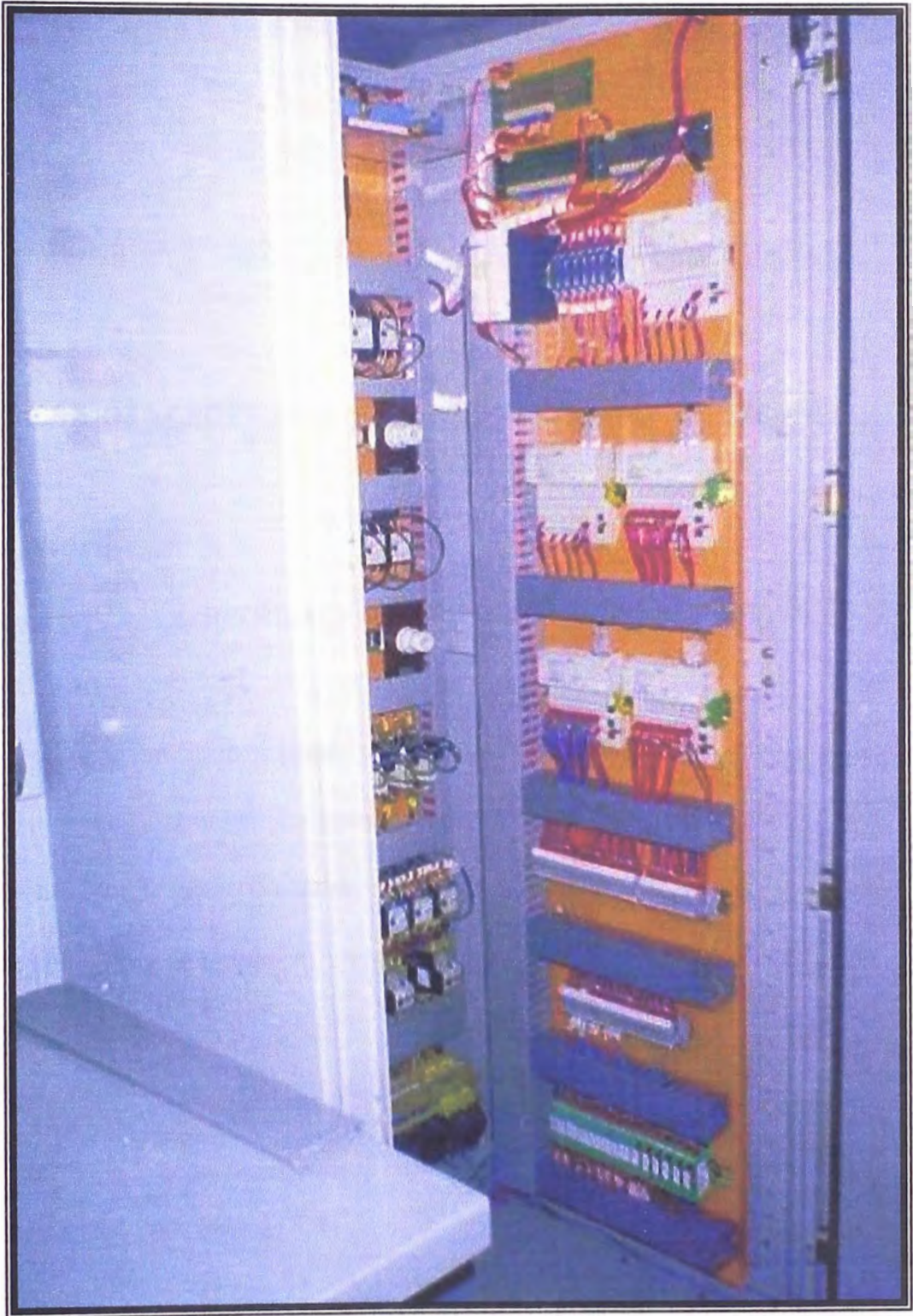
VISTA QUE MUESTRA LOS DISPOSITIVOS QUE COMPLEMENTAN EL PLC.
