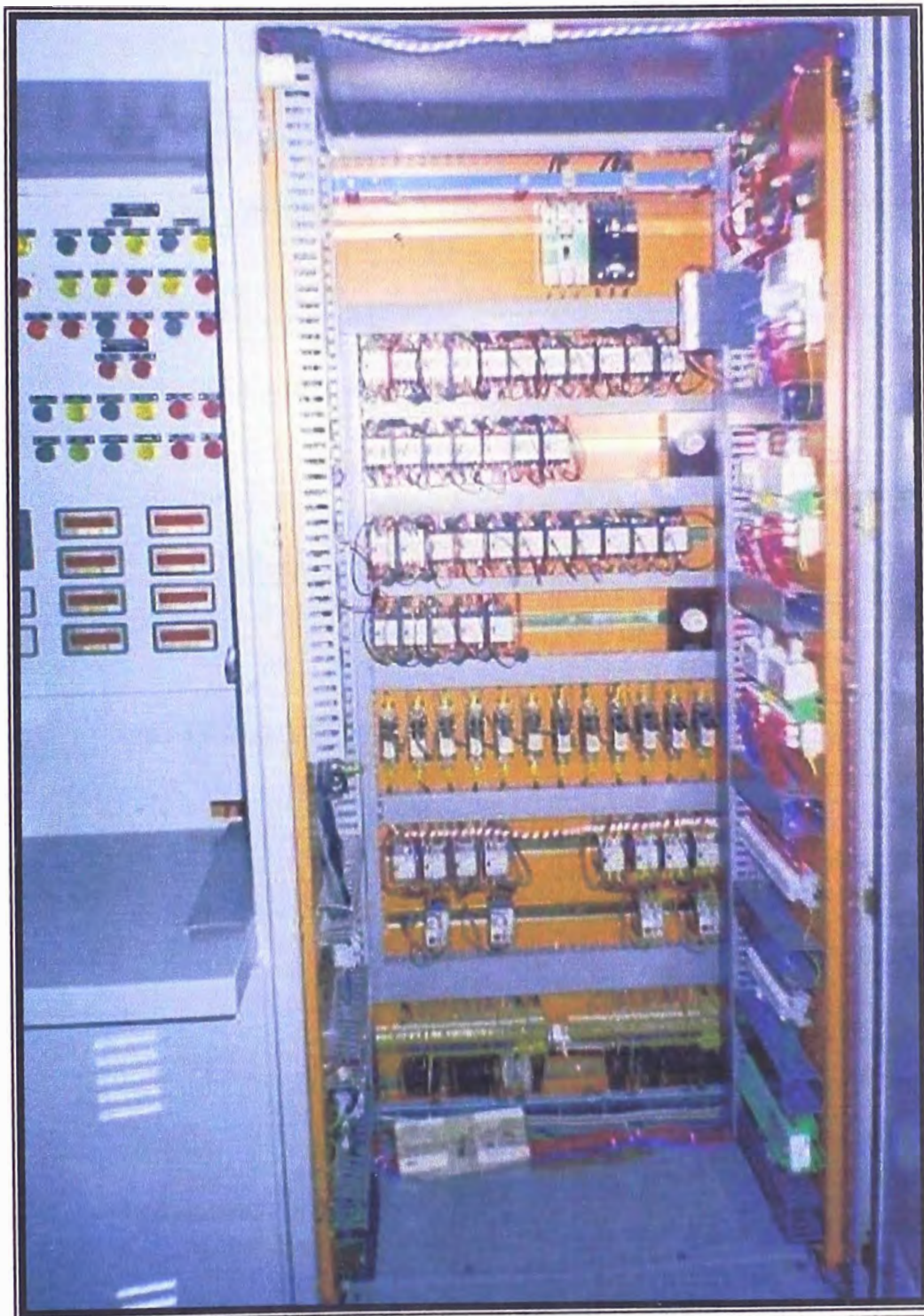
VISTA INTERIOR (LADO DERECHO) DEL TABLERO DE CONTROL
