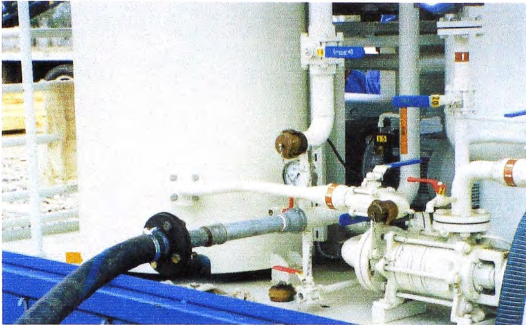
9.1 Sistema de vacío de la planta de termo-vacío
