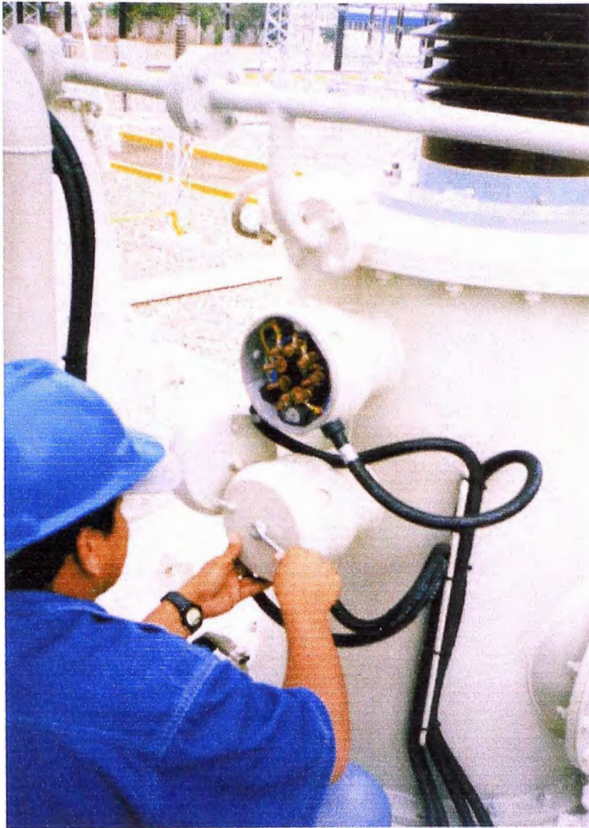
10.1 Conexión de las salidas del secundario de los transformadores de corriente
