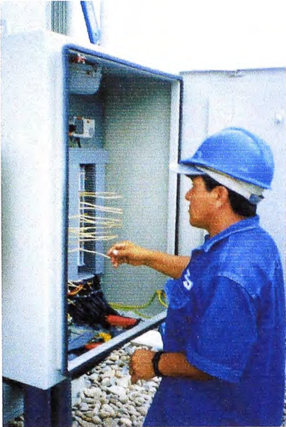
11.1 Conexión de cableado en caja de distribución del reactor
