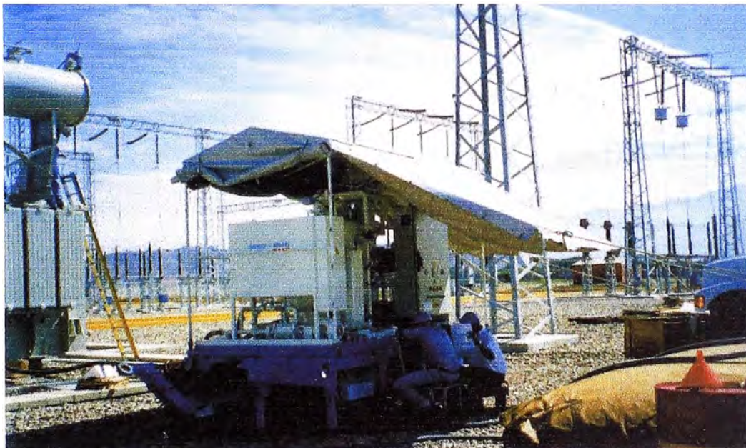
9.2 Control del proceso de vacío del reactor 20 MVar
