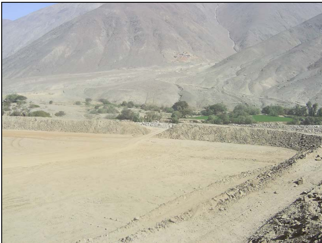
Fotografía No. 8.- Nuevo depósito de relaves en construcción aguas debajo de la actual relavera
