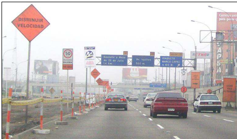
Fig. 2.10 Señalización para Obras muy agresiva, porque tiene mucha información.
