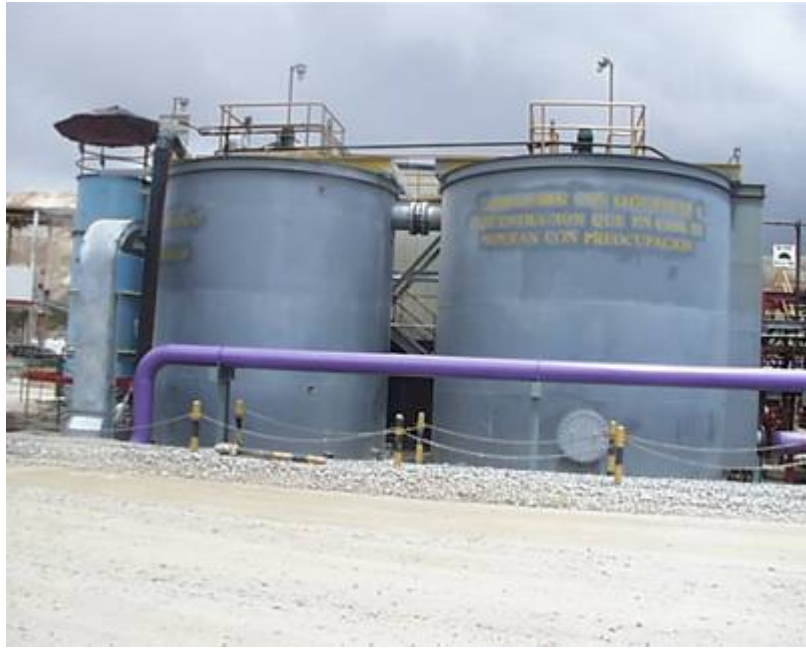
Figura 8. Tanques para la Destrucción de Cianuro
