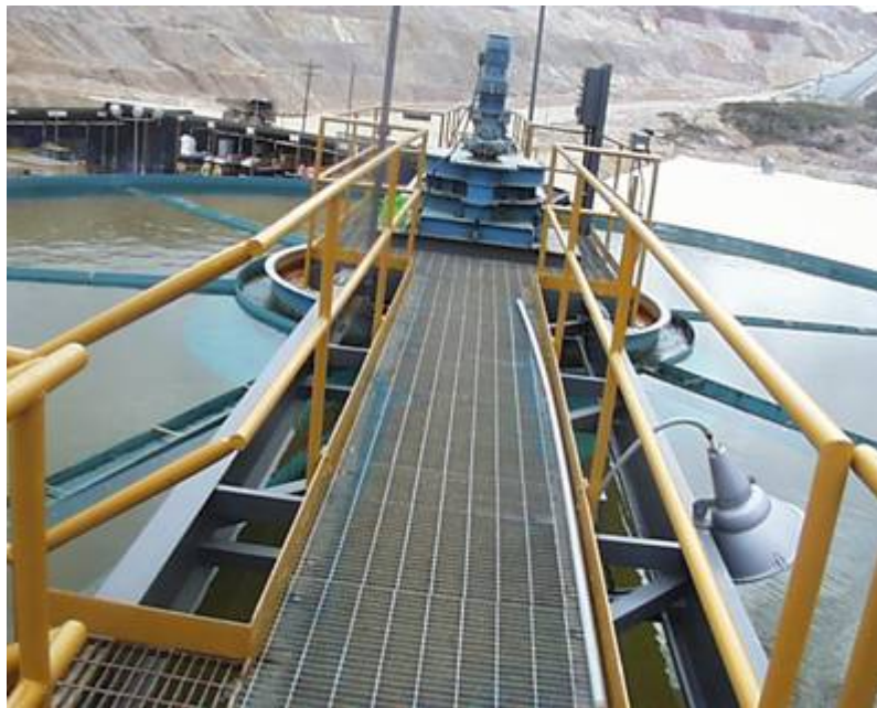
Figura 11. Clarificación y filtración del agua y separación de lodos
