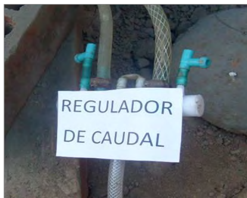
Figura 22. Regulador del caudal de aire para el sistema de difusores.
