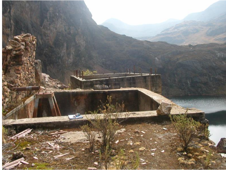
Figura III.6 Pozas de Almacenamiento de agua
