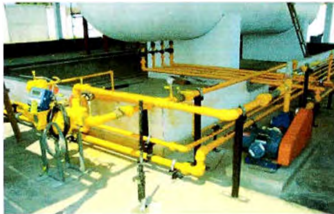
Figura 2-8 Tuberías y válvulas de la red de GLP
