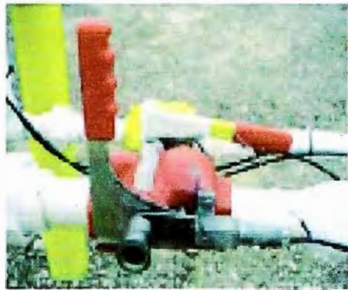
2.- Cierre remoto de válvulas internas
