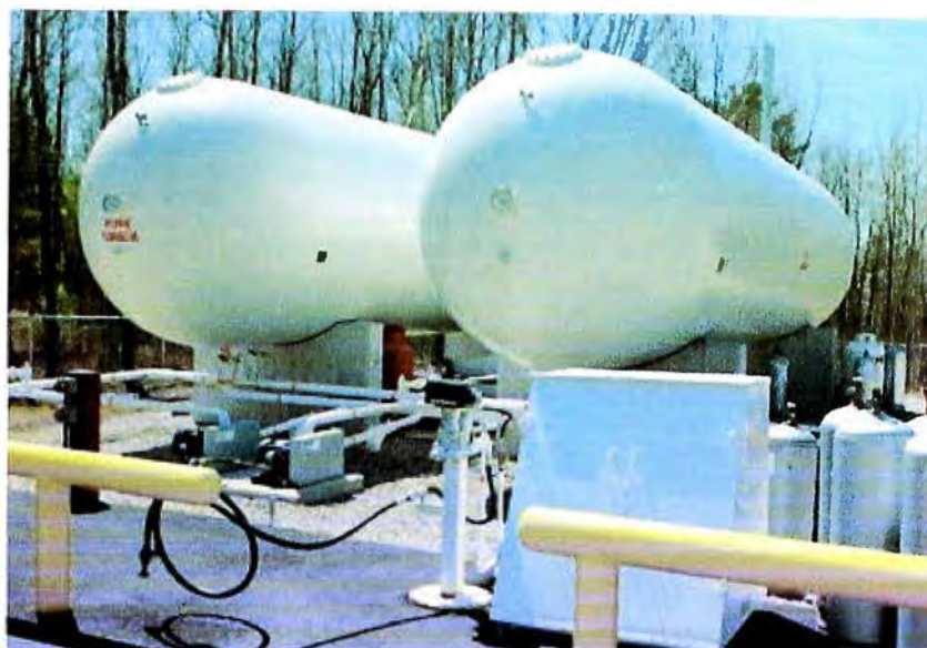
Figura 7-1 Tanques de almacenamiento de GLP
