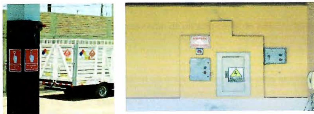
Figura 7-5 Interruptores generales a prueba de explosión
