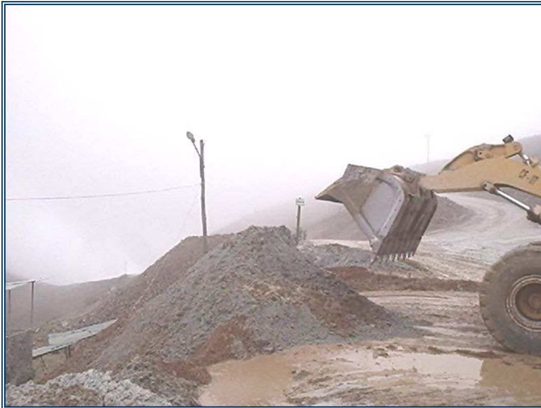
Fig. 20: Alimentación de la Rampa
