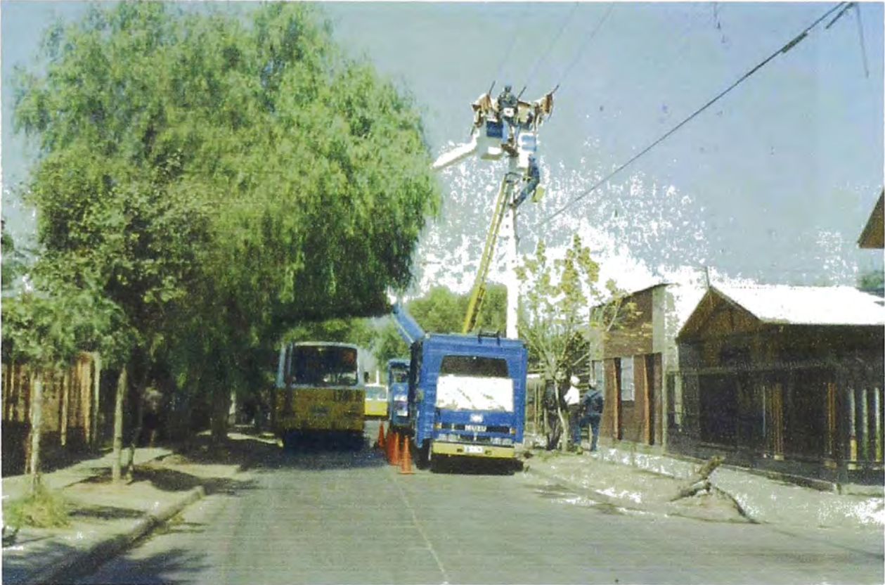
Fig. IV-5 Señalización en la zona de trabajo en media tensión (solo a modo Informativo)
