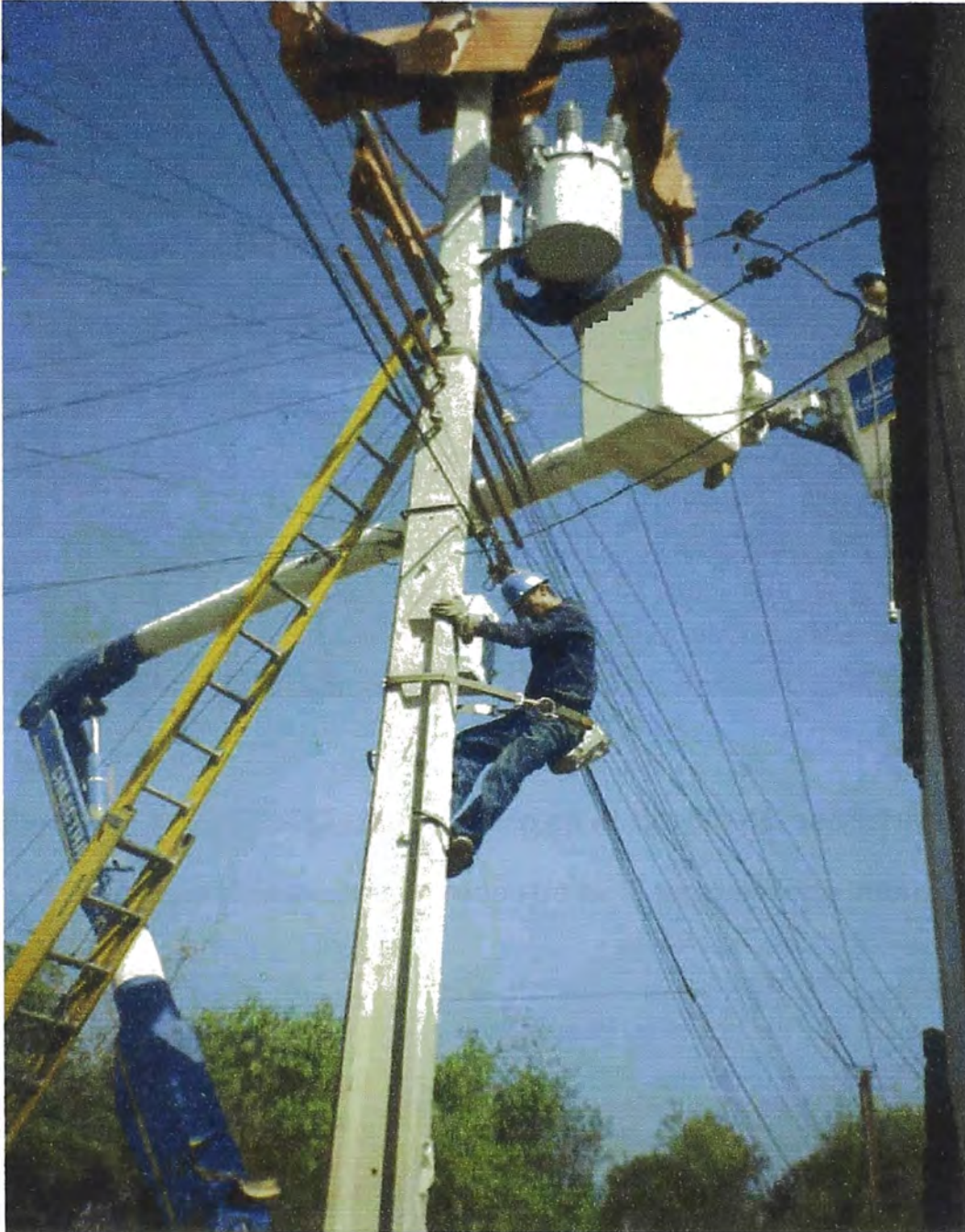
Fig. IV-6 Instalación de transformador en líneas energizadas en redes MT. (22.9 kV) y B.T. aéreas (solo a modo informativo)
