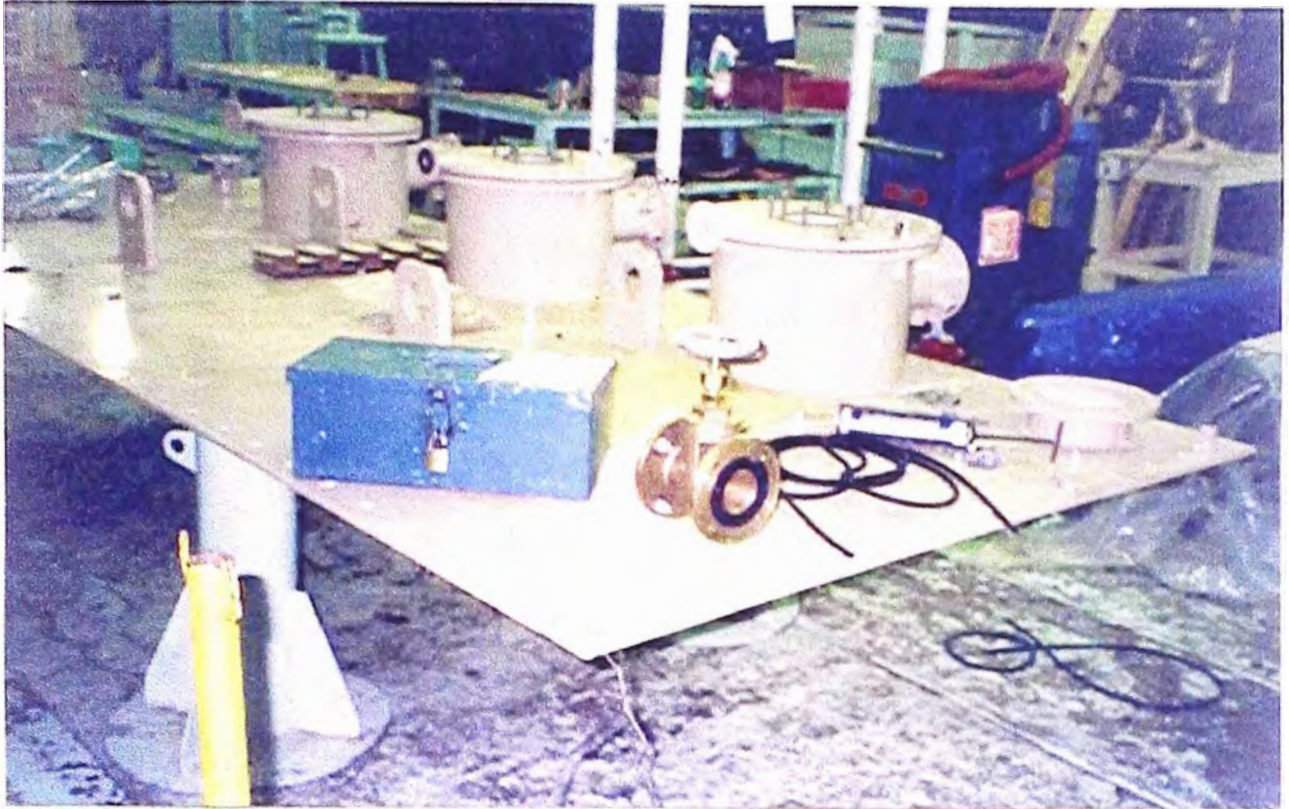
Tapa Superior del Transformador
