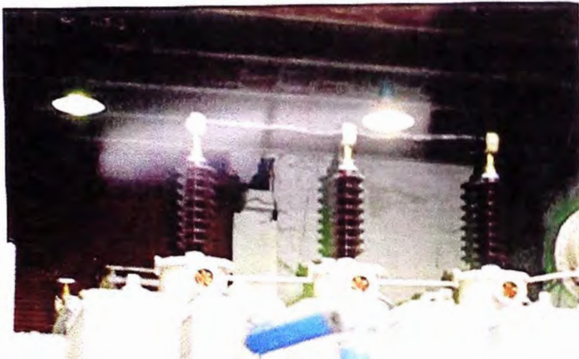
Transformador Mostrando Bornes de AT en Cortocircuito.
