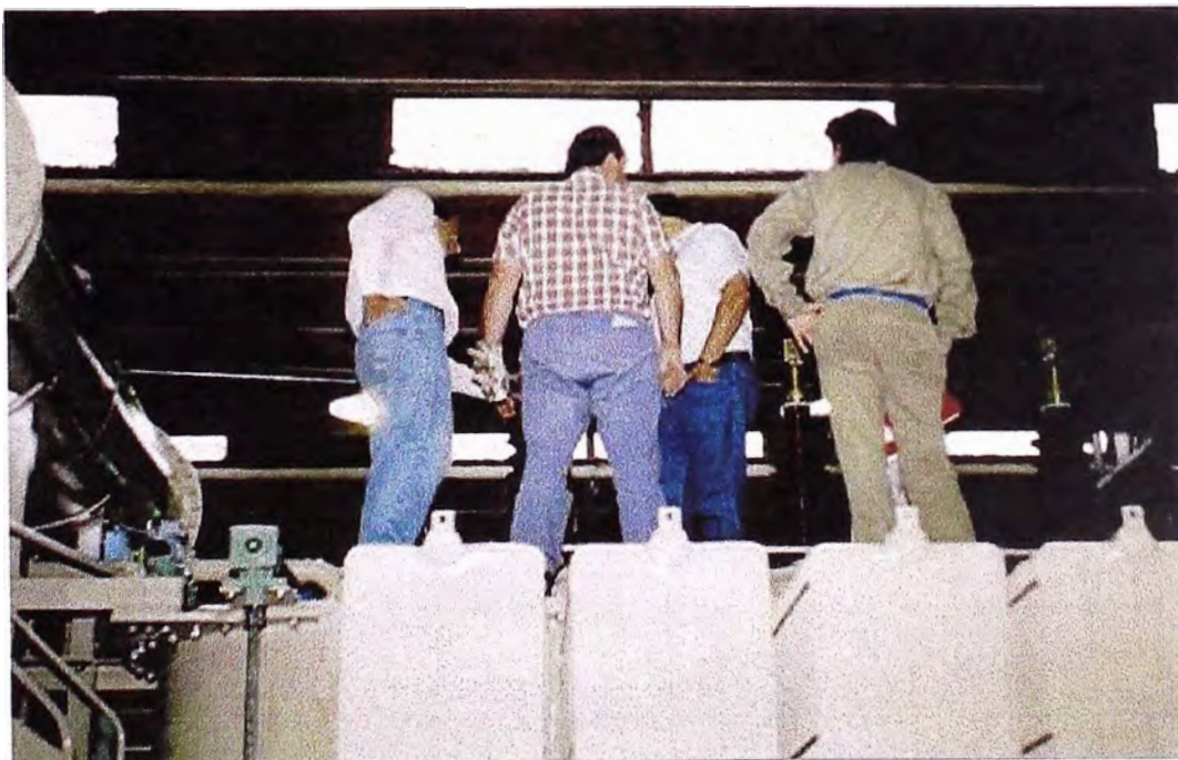
Parte superior del transformador mostrando el relé Buccholz.
