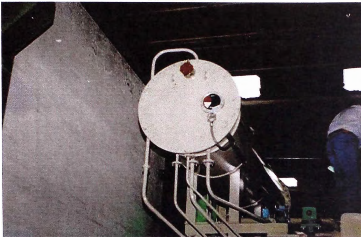
Tanque de nivel de aceite del Transformador
