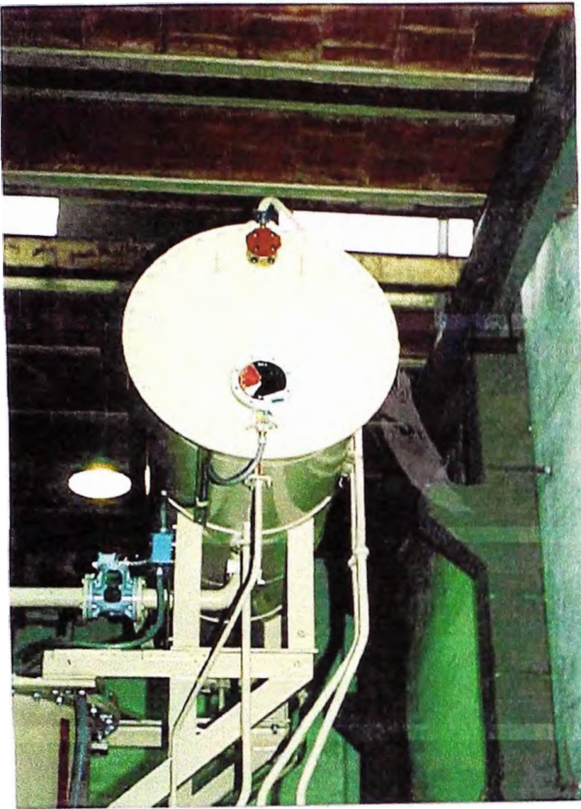
Tanque Indicador de Nivel de aceite del Transformador.
