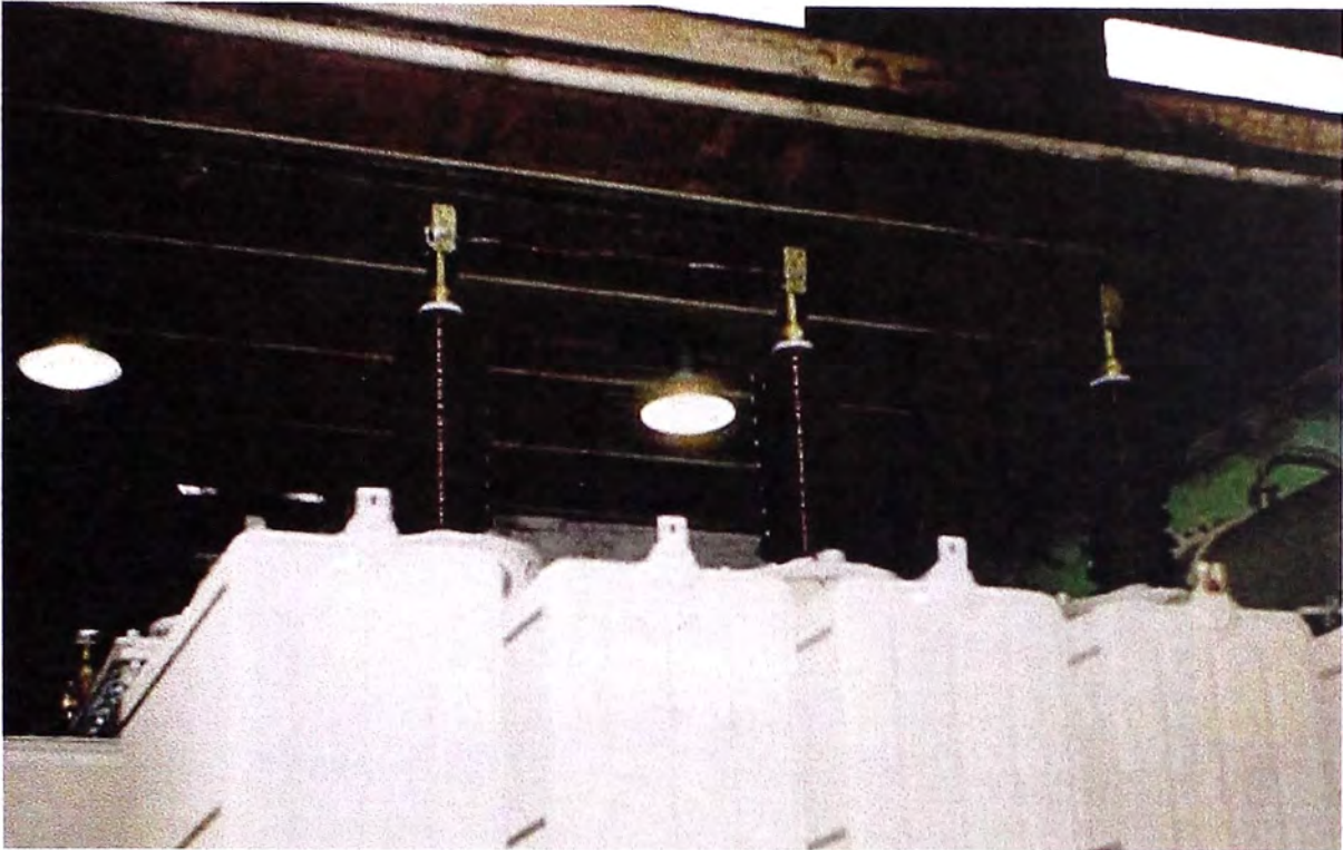
Bornes de AT del Transformador
