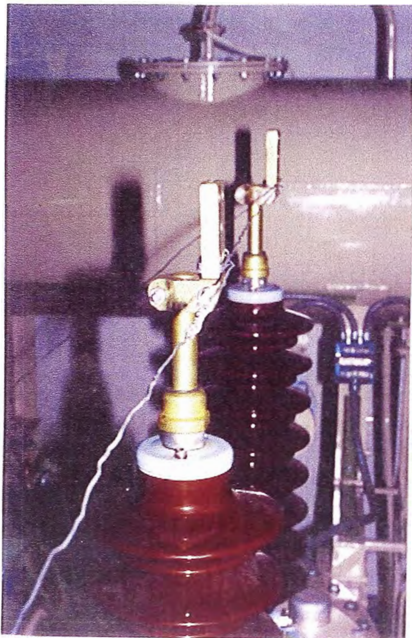
Bornes de AT en cortocircuito
