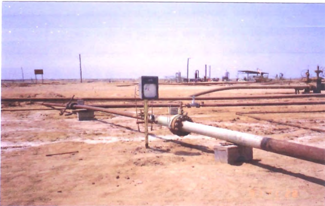
FOTO 7.2 BRIDA DE ORIFICO En la industria petrolera, medir y fiscalizar la producción de gas natural es tan vital e importante que sirve para valorizar este recurso energético no renovable; Lo más básico es una Brida de orificio con su registrador de presión y temperatura como se observa en la foto de la Batería de Carrizo-605 en Talara.
