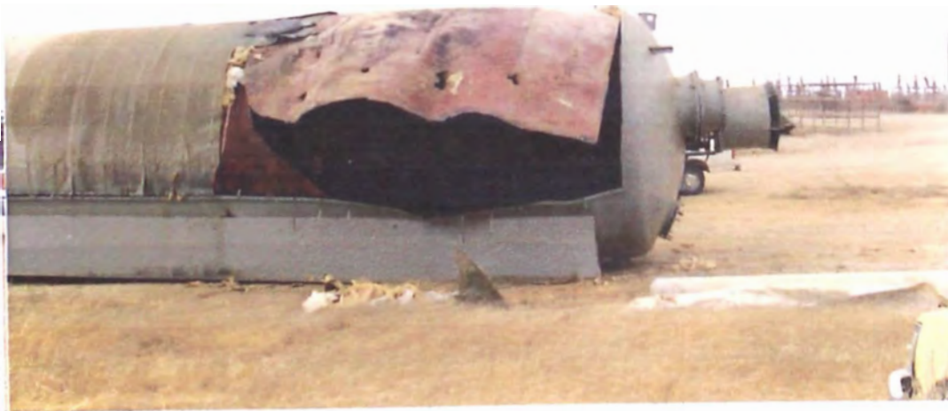
FOTO 8.6 EXPLOSION DE UN TRATADOR POR EXCESO DE PRESION En este caso el llenado del tanque se hizo de noche y no se dejó un desfogue, falló la válvula de seguridad y faltó supervisión y la presión de llenado excedió el límite máximo de la presión de diseño y el tanque explotó. Recomendación nunca realizar una prueba hidrostática de noche. En la foto se observa que la falla ocurrió en la pared lateral que siempre es más delgada que en el casquete. Talara.
