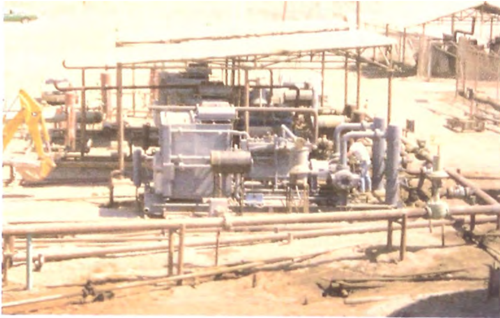
FOTO 7.1 ESTACION DE COMPRESION BATERIA ON-988 Los compresores reciprocantes con motores a gas de alta velocidad (600 a 1200 rpm ) con relaciones de compresión entre 2.5 y 6.5 presentaron buena eficiencia ( 80% ) con presiones de descarga entre 20 y 260 psig y volumen de gas entre 1.0 a 2.5 MMSCF/D en el Proyecto de Recuperación Secundaria en Talara.
