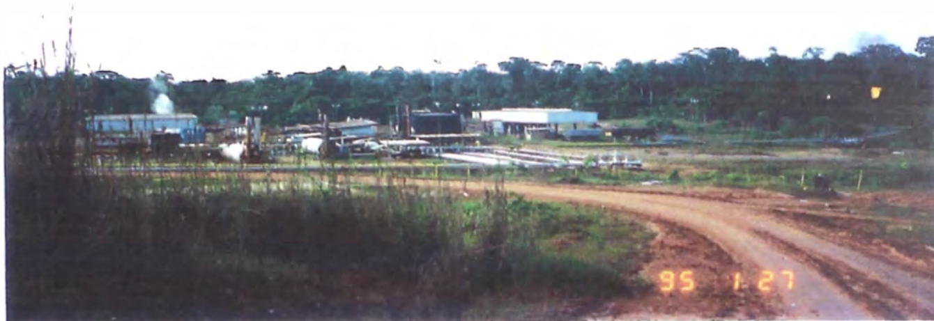
FOTO 5.1 LAS PLANTAS DE TRATAMIENTO DE CRUDO, llamadas Baterías en la costa y plantas en la selva tienen por finalidad separar el aceite, el gas, y el agua de formación que producen los pozos de un determinado reservorio ó área de producción, bajo condiciones de operación continua, segura y confiable; Los parámetros de presión, temperatura, caudal y otras características son diferentes en cada región; En la foto se observa la Planta de Dorissa, lote 1-AB Selva.
