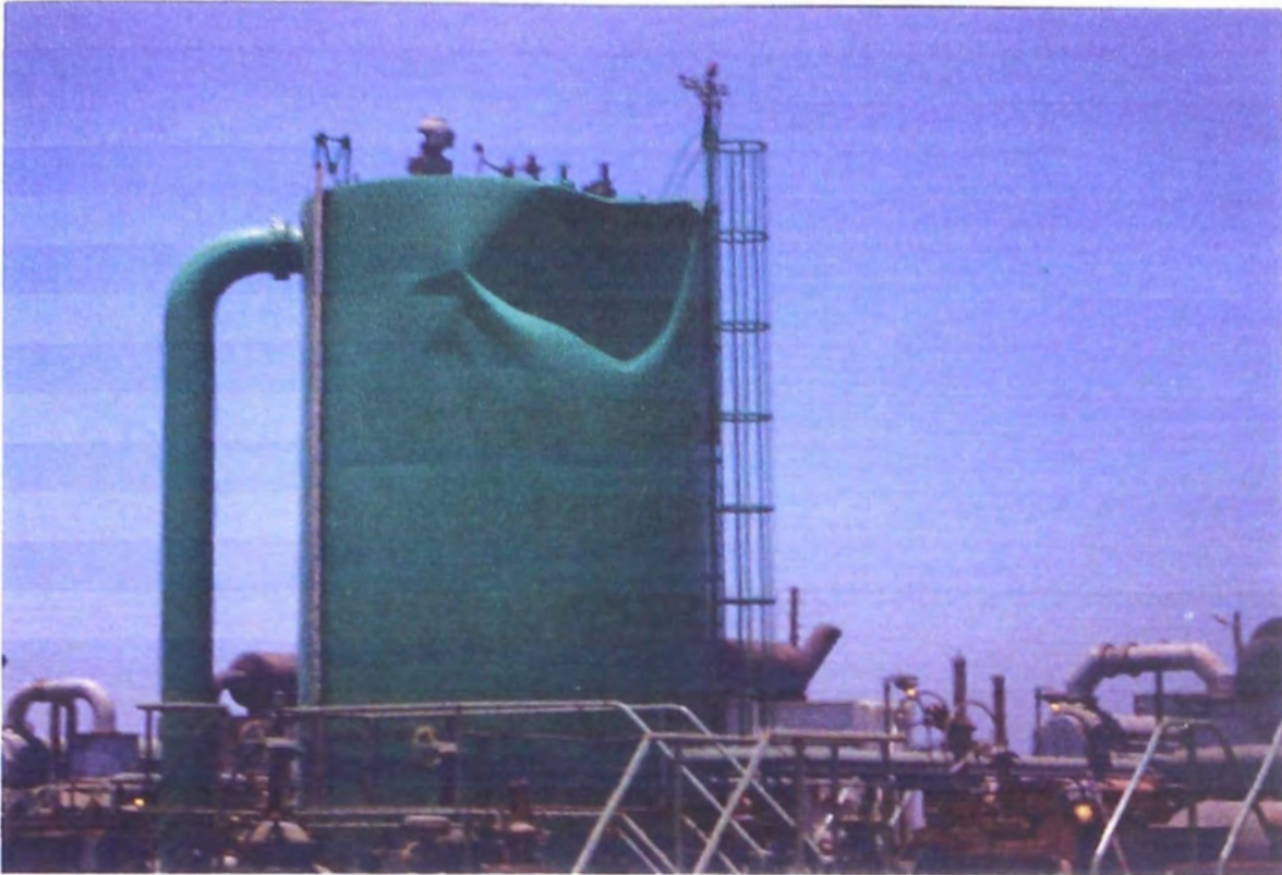
FOTO 8.5 COLAPSAMIENTO DE UN TANQUE DE CEBADO EN PLANTA DE INYECCION Cuando las condiciones de operación de un recipiente a presión están fuera de sus parámetros de trabajo ocurre un daño que puede ser de consecuencias incalculables para la empresa; En la foto se observa un tanque de 1,000 barriles que colapsó debido a que la Válvula de seguridad no se abrió al producirse un vacío, no hubo abastecimiento de agua, falló la alarma por bajo nivel y no hubo comunicación entre los operadores de las plantas.
