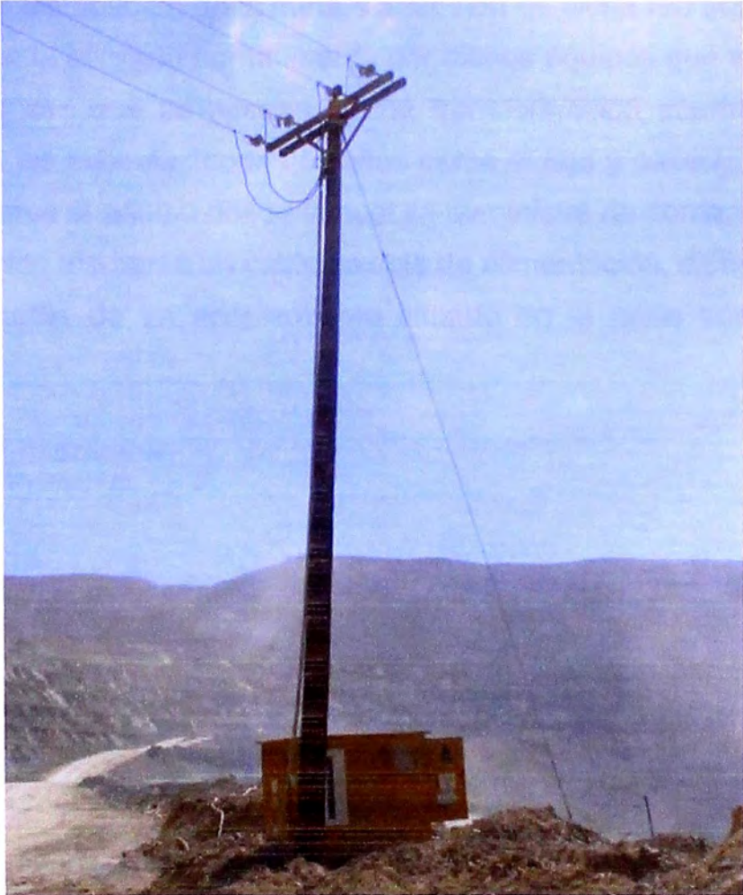
Poste de Alta Tensión y Caseta Interior Mina
