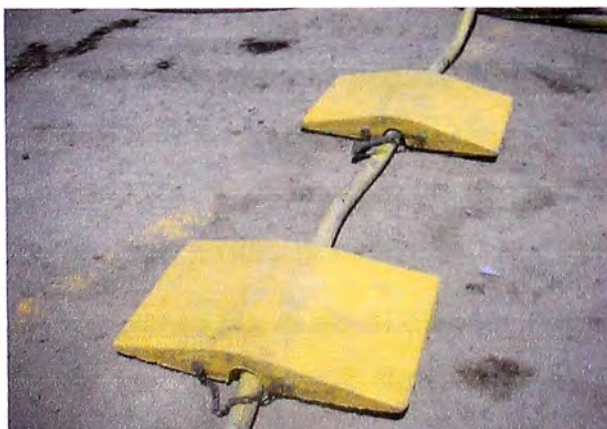
Es prioridad la colocación de puentes livianos aislantes sobre los cables a fin de evitar daños por aplastamiento debido al tránsito de camionetas y/o otros equipos livianos.
