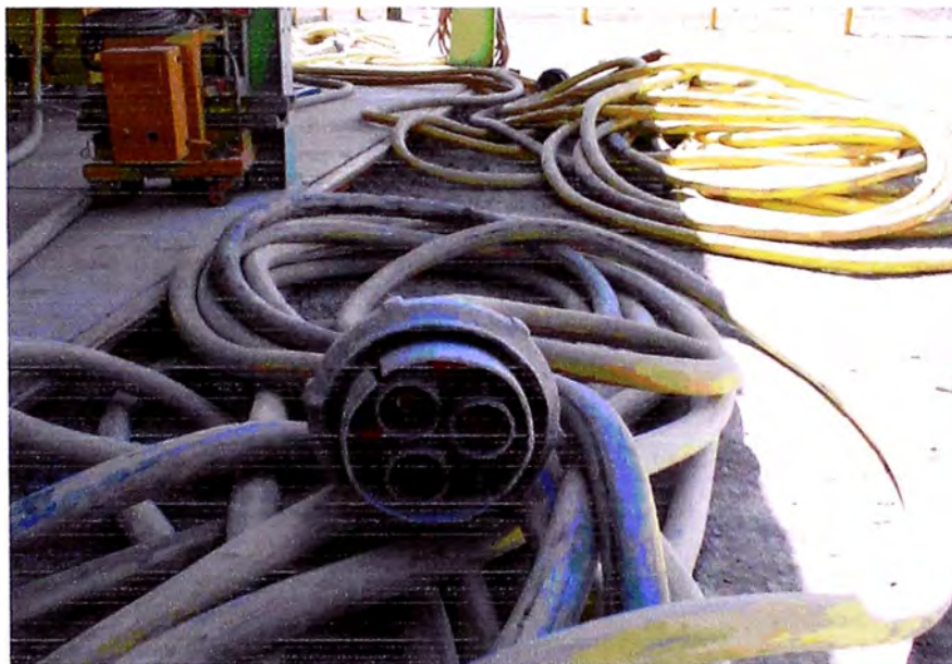
Disposición de Cable de Energía en el Taller Electricidad Mina
